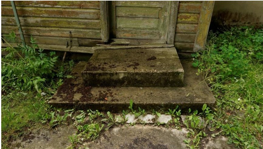
Ill 20. Vajunud betoonastmed. Foto: Delija Thakur, 2022
