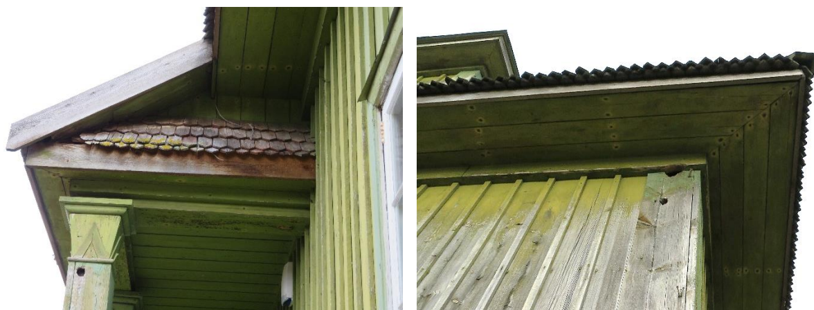
43-44 Peaukse sissepääsu varikatusel tuulekasti all säilinud algsed kimmid. Elamu räästakasti nurgalahendus. Üleva paistab vintskapi väiksema eenduvusega räästakast. (Autori fotod)
