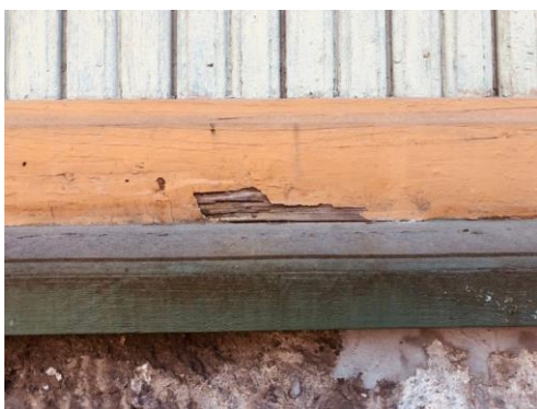
Joonis 28. Fassaadi stardilaud on pehkinud ja värv koorub (autori foto)
