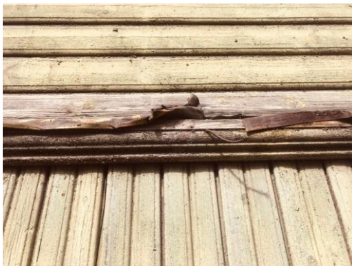
Joonis 24. Välisseinte veeplekid (autori foto)
