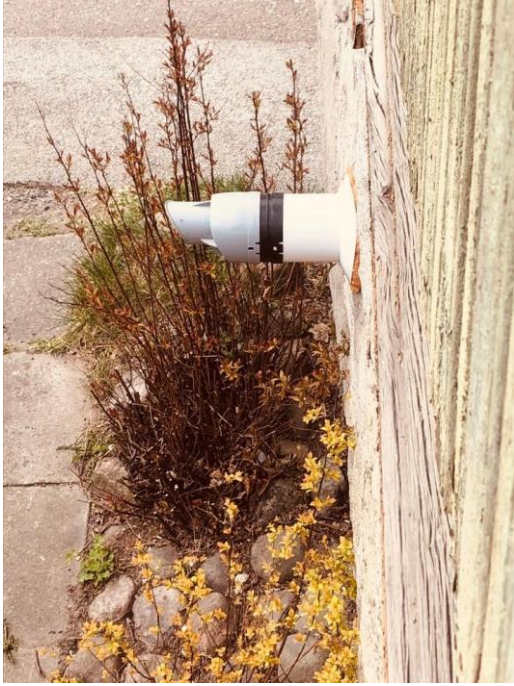
Joonis 21. Soklil gaasikütte ventilatsiooni õhutusava (autori foto)
