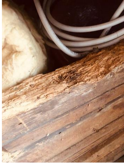
Joonis 56. Pööningul puidu kahjustused (autori foto)
