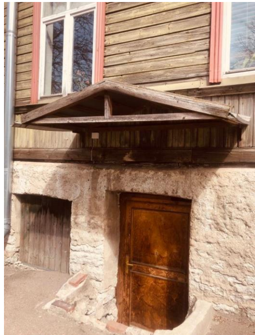
Joonis 36. Varikatus tagafassaadi keldriukse kohal. Niiskuskahjustused fassaadil.
