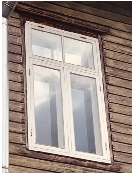
Joonis 43. Puuduvad piirdeliistud, alumine aknakarniis
