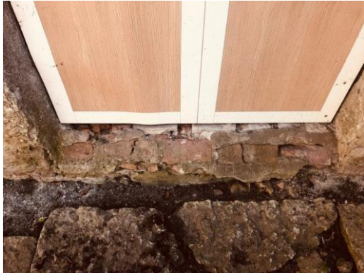
Joonis 48. Laminaatkattega keldriaken, niiskuskahjustus sokli alaservas
