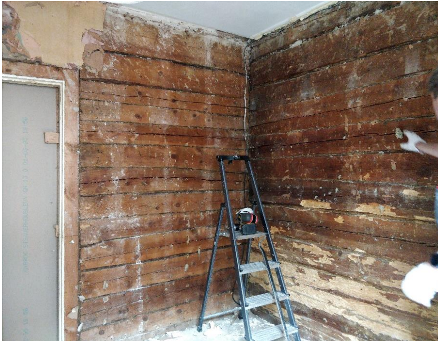
Pilt 77. Rõhtpalgi seisukord. Vasakul näha kinniehitatud ust. Paremalt puukoide hävitustööd.
