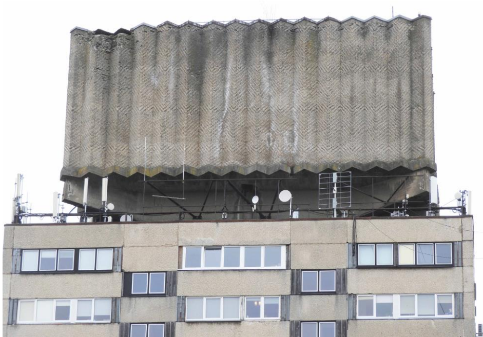
Illustratsioon 38. Kiviseina ja konsooltalade kahjustused.
