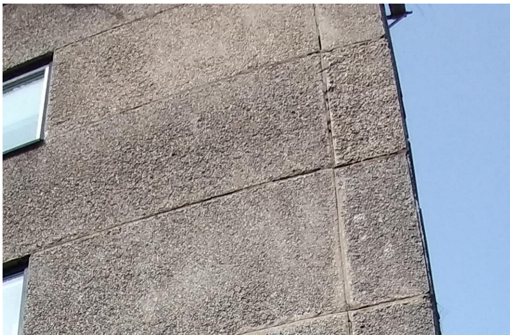
Illustratsioon 33. Osad välisseinapaneelide vuugid pudenevad ja pragunevad. Pildil hoone kirdepoolne nurk.
