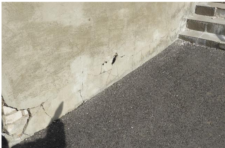
Illustratsioon 30. Sokliseina niiskuskahjustused.
