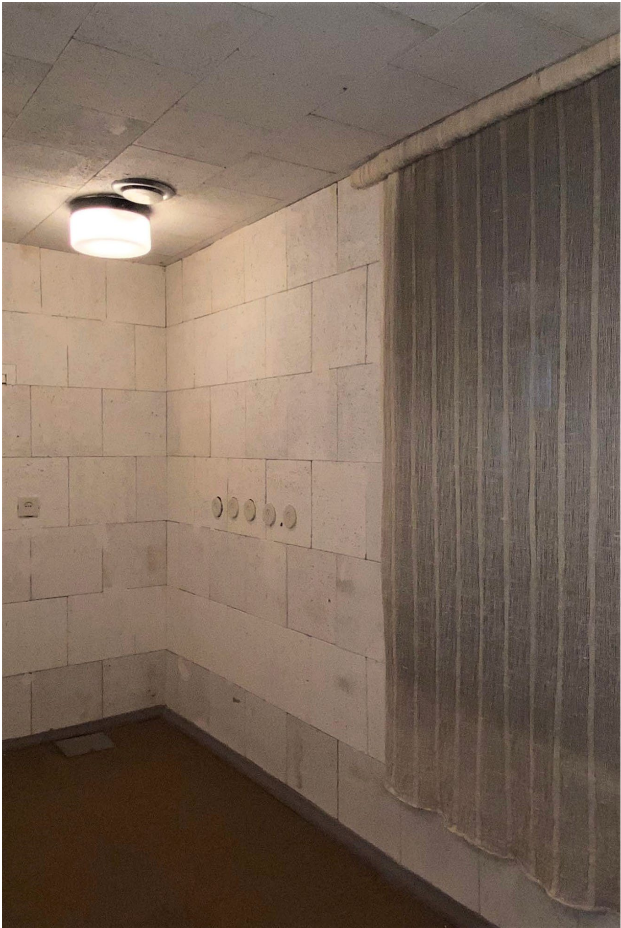
Foto 7: 2.korruse kohtusaali abiruum. Seintel on algupäraseid akustilised plaadid ning tundub, et ka algupärane kardin. Selle asemel aga, et kardinakangas korralikult palistada on see „kardinapuu“ ümber rulli keeratud. Säilinud on ka algupäraseid pistikupesad ja laevalgustid.
