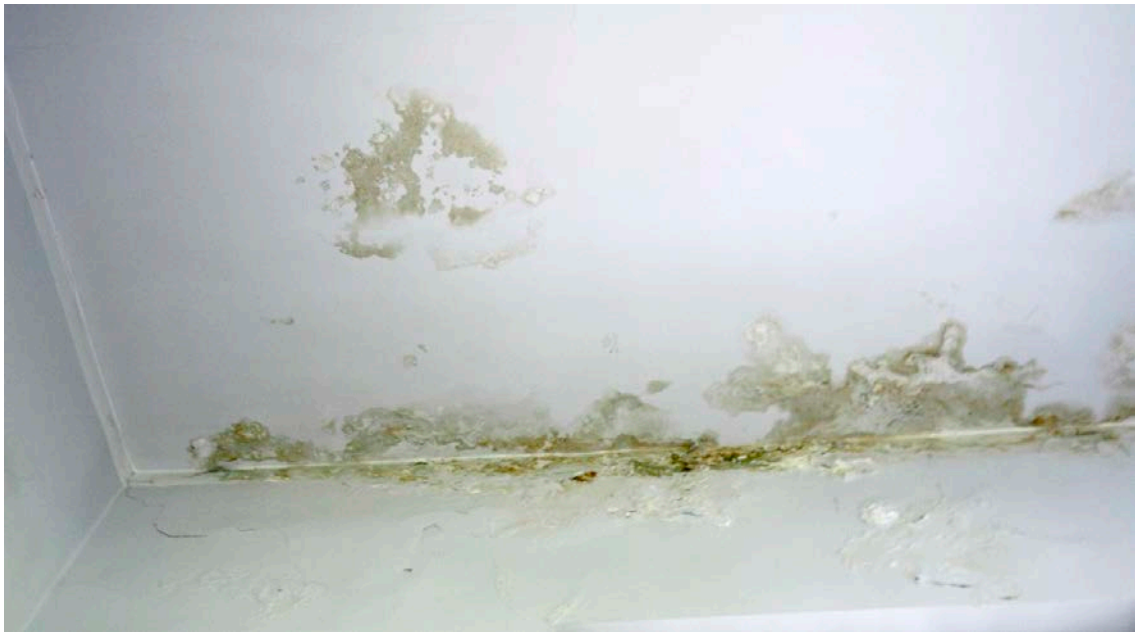
Foto 43: Niiskuskahjustus peasissepääsu eeskoja laes
