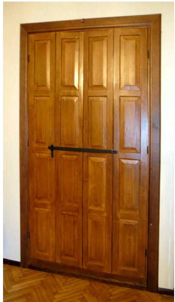
Foto 95: Aknaluugid kapiustena ruumis nr 39
