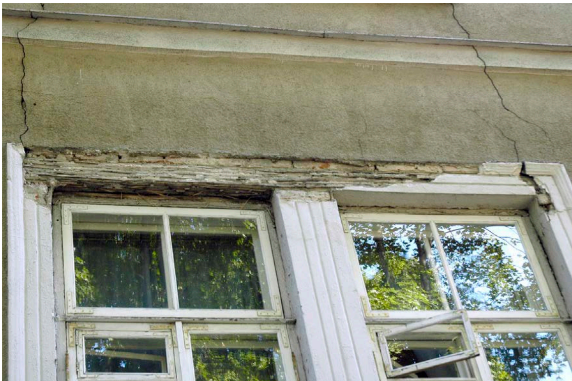
Foto 23: Läänefassaadil paljandub murenenud krohvi alt I korruse akende puitsillus. Hoone fassaadil on praod, mis on tekkinud eeldatavalt vajumisest (võimalik, et pärast II korruse pealeehitamist 1980-ndatel).
