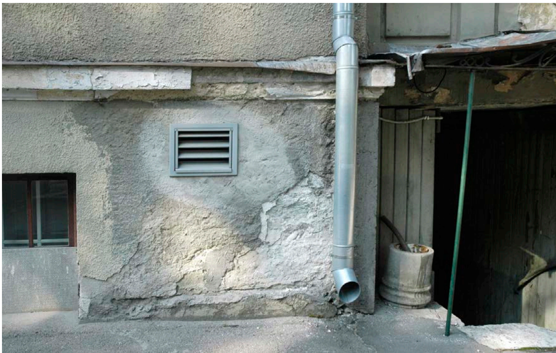
Foto 16, 17: Murenev krohv ja krohvikarniis sokliosas. Sokliosia krohviparandused on tehtud tsementkrohviga. Keldriakende alumine osa on kinnikaetud, et takistada vee sattumist keldrisse, kuna vastu maapinda paiknevad aknaraamid on läbimädanenud.
