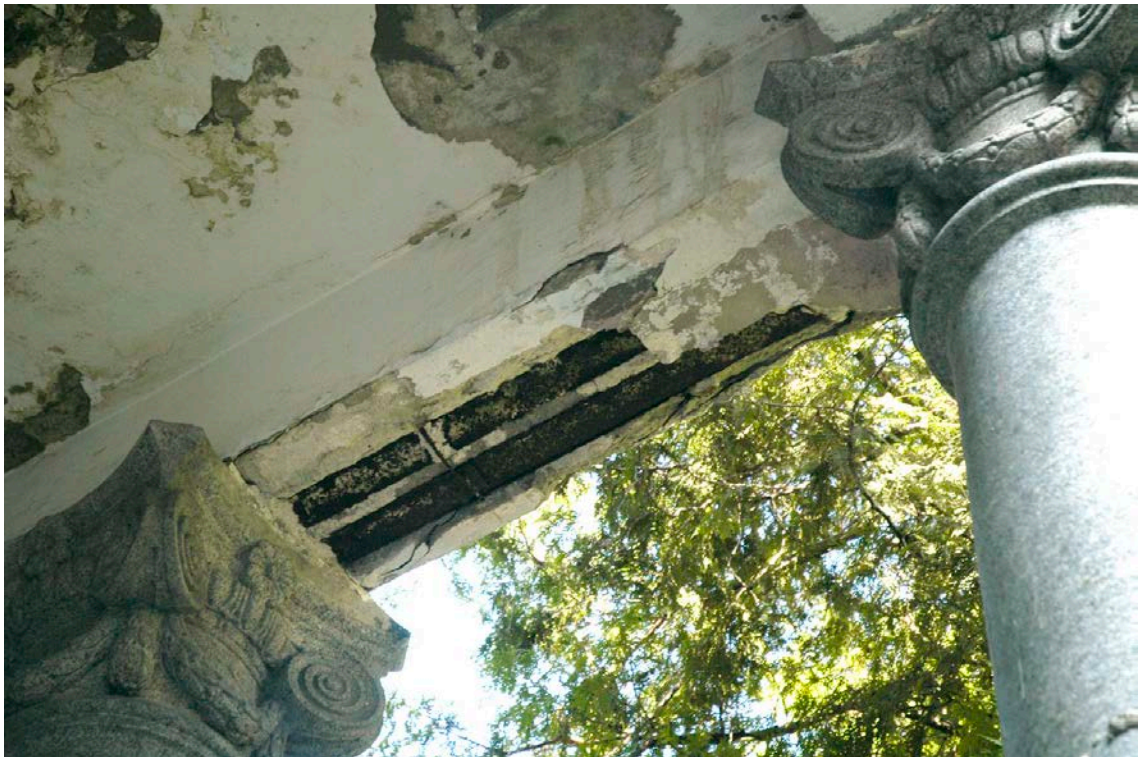
Foto 19: Tugevad niiskuskahjustused peahoone rōdualuses
