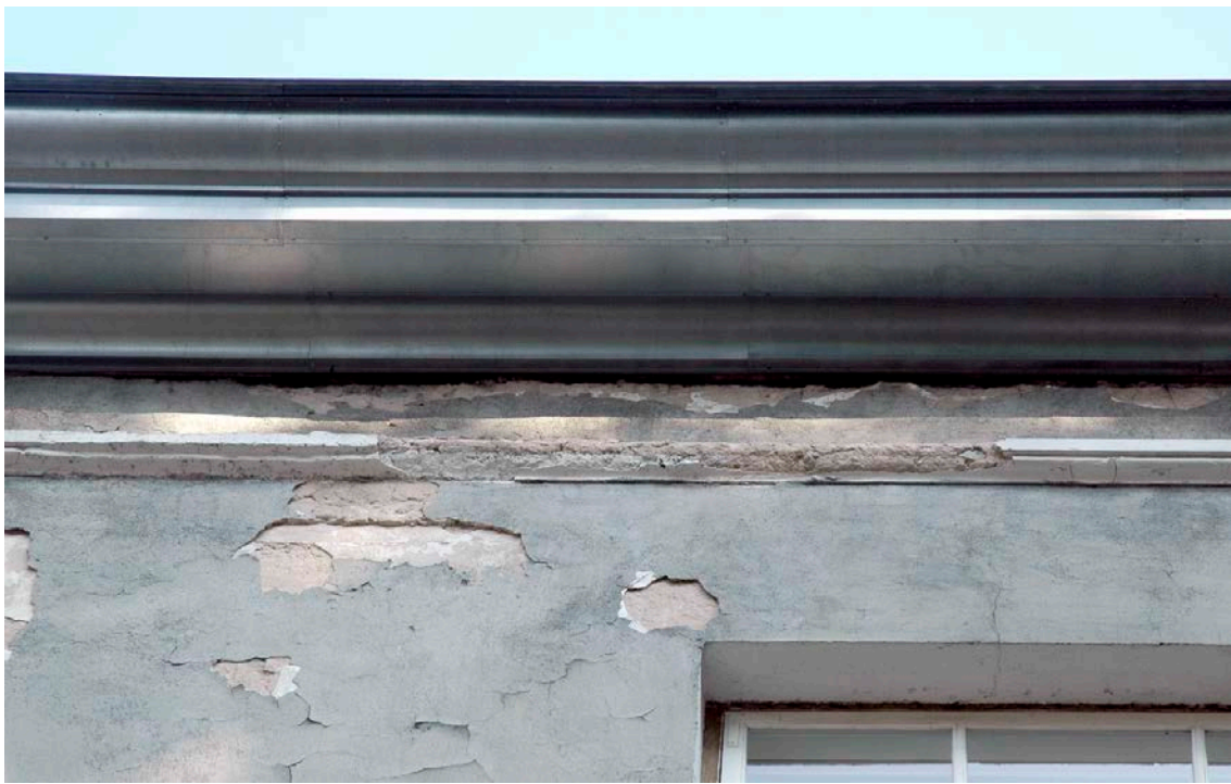
Foto 22: Murenev krohvikarniis tagafassaadil. Hoonele on paigaldatud uus plekk-karniis.
