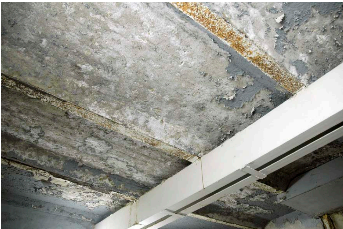
Foto 44: Niiskusest tugevalt kahjustunud ja toestatud lagi soojasõlme ruumis.
