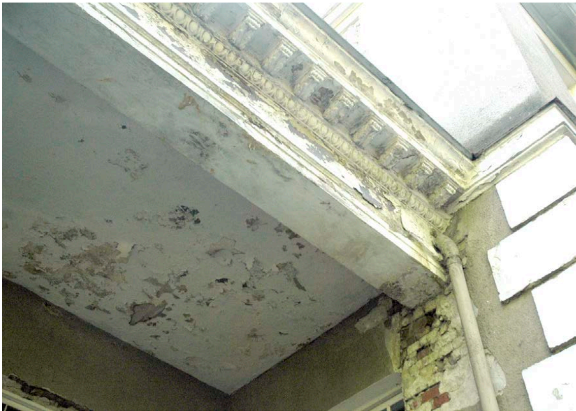
Foto 21: Niiskuskahjustused rōdu alusel seinapinnal
