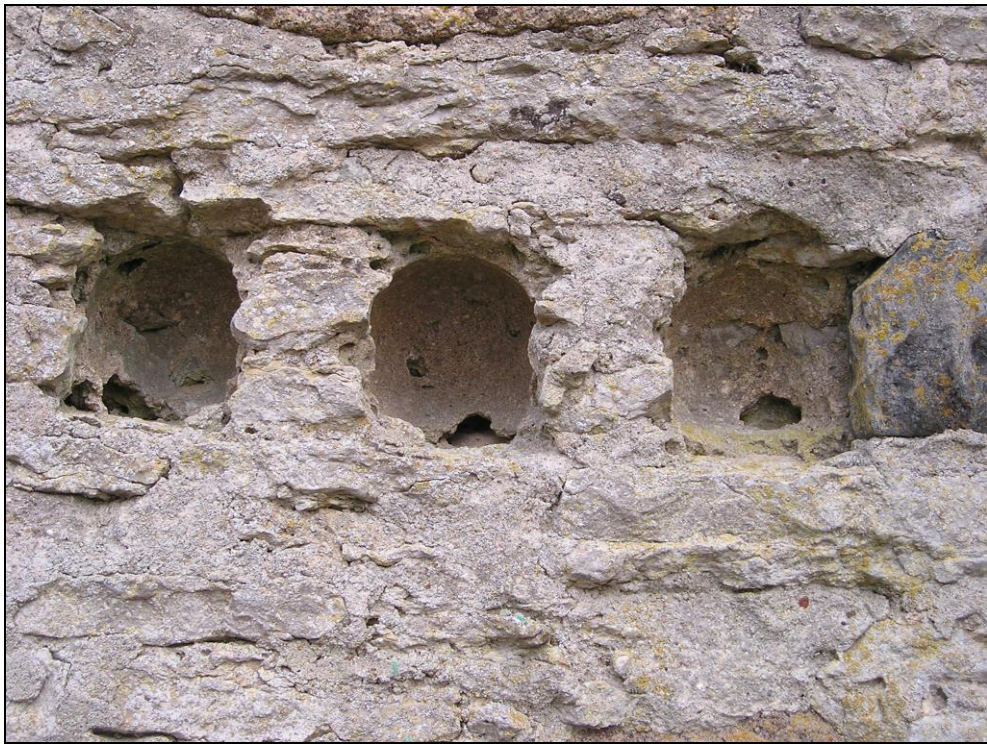
Foto 10. Läänefassaadi põhjaosas asuvad kolm lohku.
