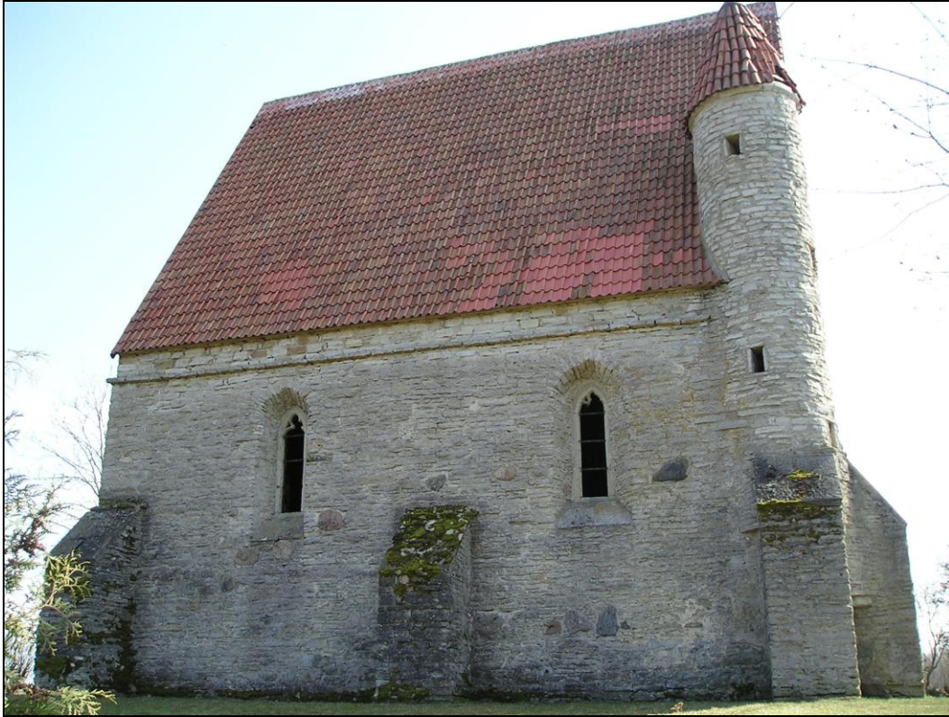
Foto 15. Kabeli põhjakülg. Keskmise kontraforss on eriti sammaldunud.
