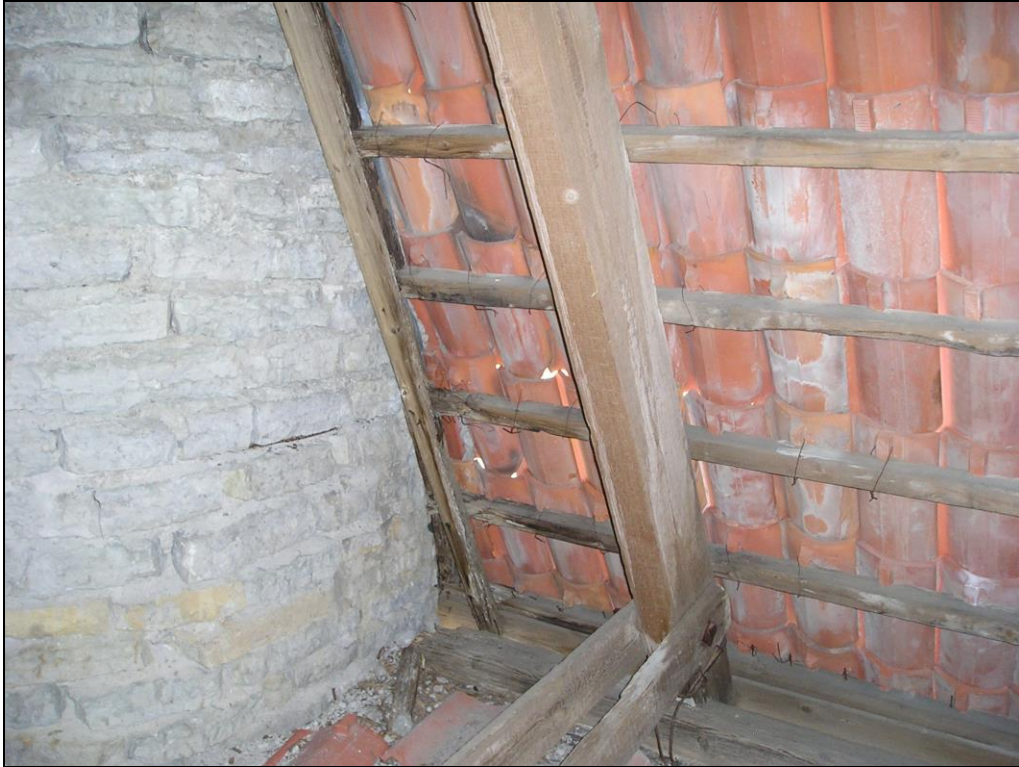
Foto 25. Nurgatorni ja katuse lõikumine. Niiskuskahjustused.
