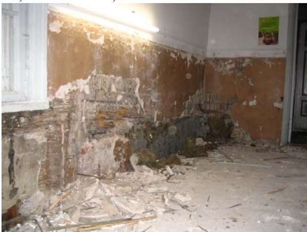
16, ruum 215 kahjustatud seinakonstruktsioon
