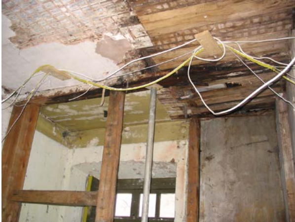
26, niiskuskahjustustega ja amortiseerunud lagi ruumis nr. 111
