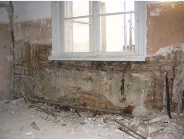
17, ruum nr. 215, aknaalused kahjustatud seinapalgid
