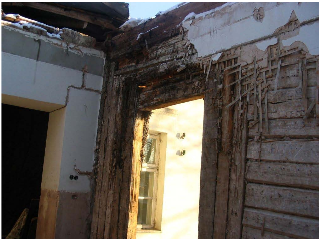
II korrus, ruumi nr 215 kahjustunud seinuosad
