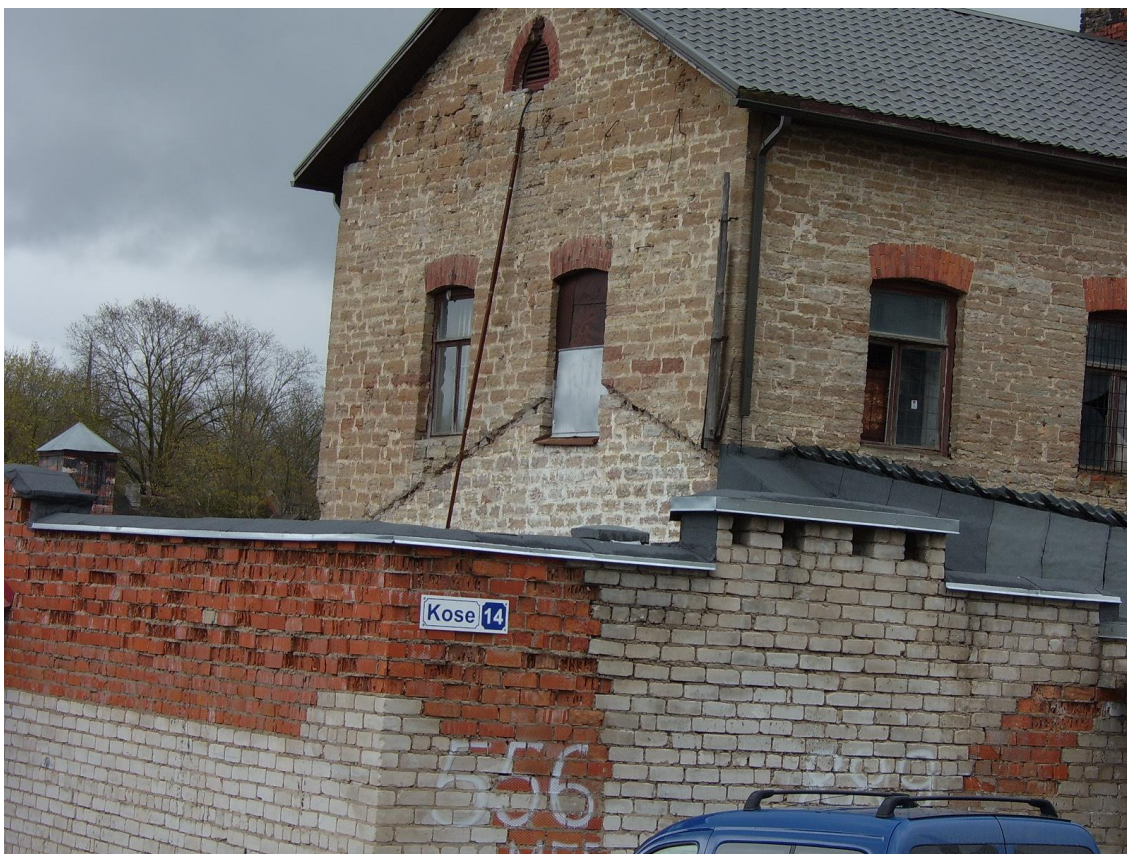
Joonis 10. Naabrihoone otsseinal vana katuse külgumise jäljed.
