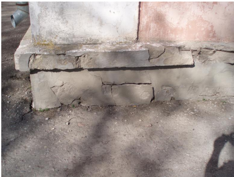
Foto nr. 4 Pragunenud vundament
