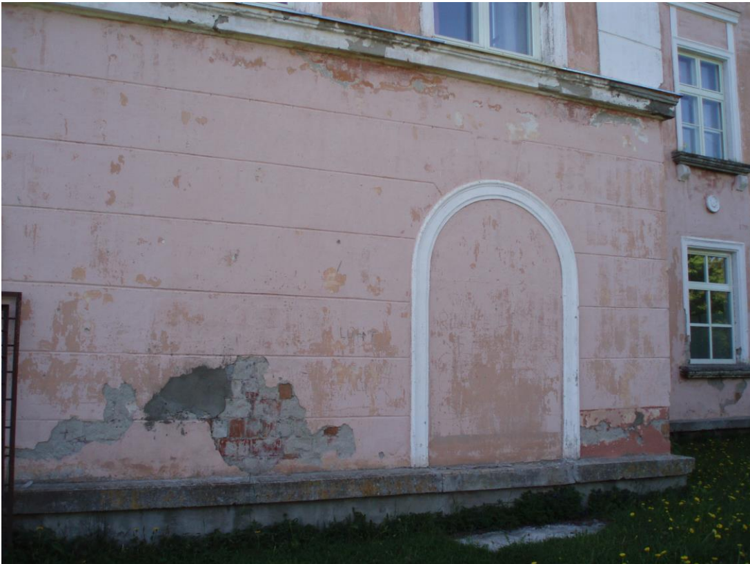
Foto nr. 6 Fassaadikahjustused
