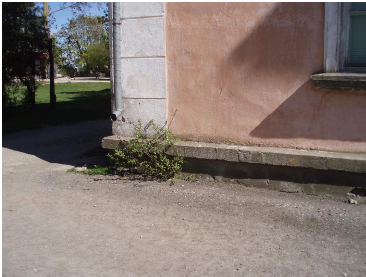
Foto nr.5 Soklit kahjustavad võsad
