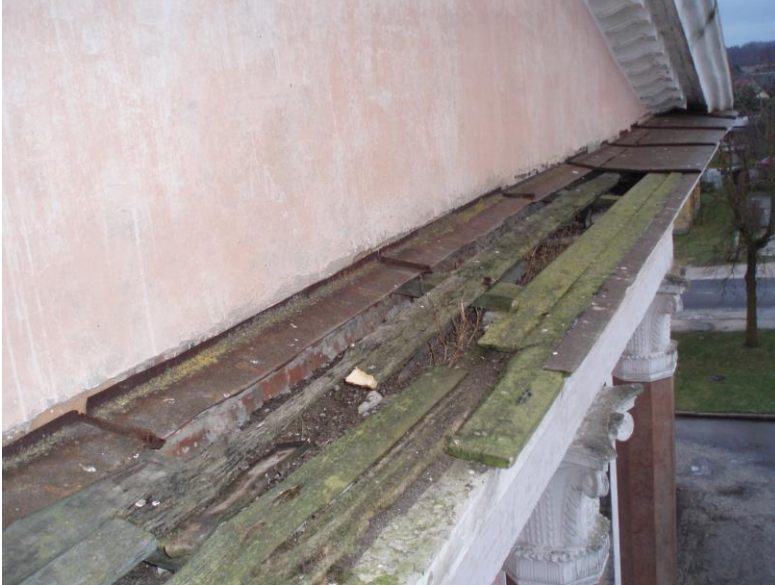
Foto nr 9 Keskrisaliidi kahjustus
