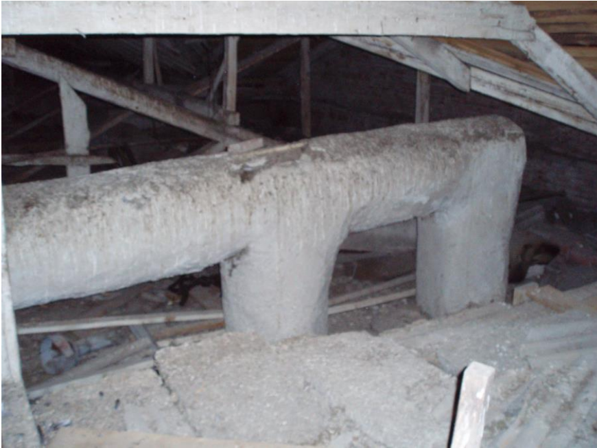
Foto nr 13 Ventilatsioonikanalid
