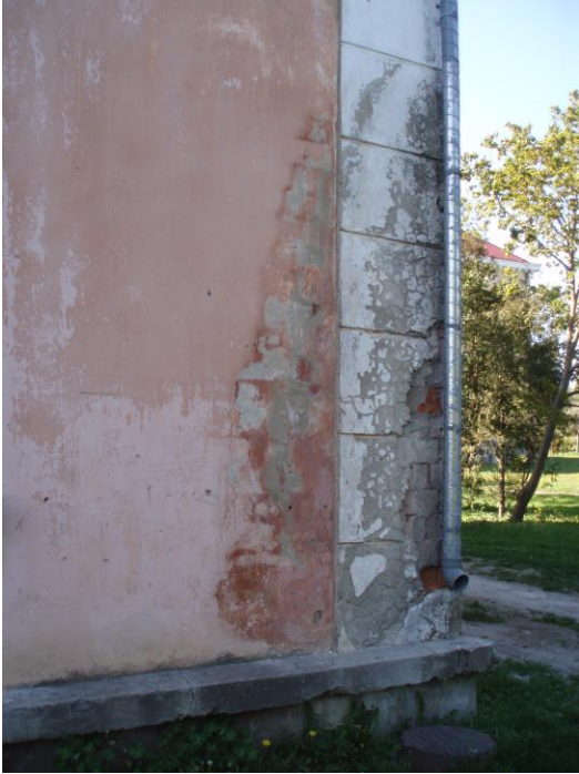
Foto nr. 7 Sadeveetoru lekkest tingitud fassaadikahjustus
