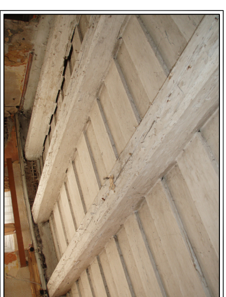
Foto nr. 72 Seina niiskuskahjustuse tõttu võlgunud laetala.
