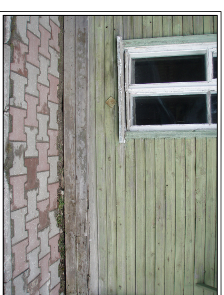
Foto nr. 7 Rüüdi tänav poole sissekäik, mis asub jooksul on jäänud pinnatööde veerul.
