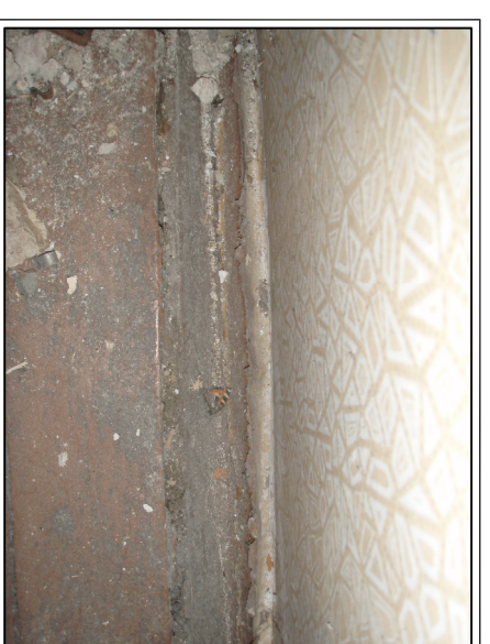
Foto nr. 61 Seina ja põranda vaheline praagu.
