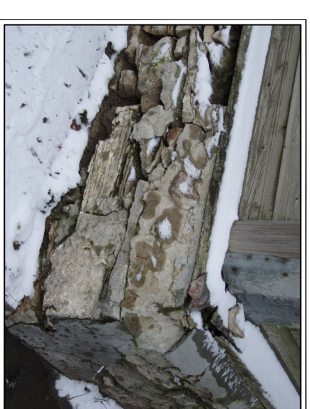
Foto nr. 8 Hoone veetudul on mitmes kohas tahvli sissekäikude ning osaliselt välisruumi sissekäikude.
