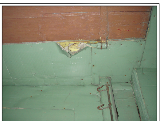
Foto nr. 67 Kõrg seina, mis on mitugi põhjusel krahitud pealisse.
