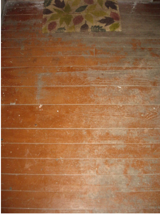
72. Puidust põrand 2.korruse koridoris.
