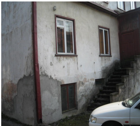
13. Vaade seinale N-nurgast, parandused tehtud mitesobiva tsementkrohviga.
