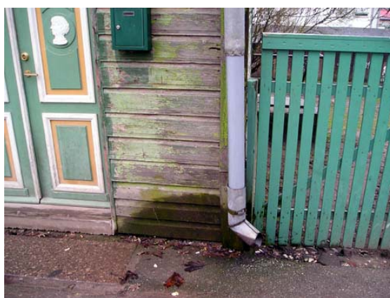
Pilt 19. Vaade märgunud voodrilaudadele halvasti toimiva sademevee ärajuhtimissüsteemi tõttu, kahjustuste tegelikku ulatust ei ole näha
