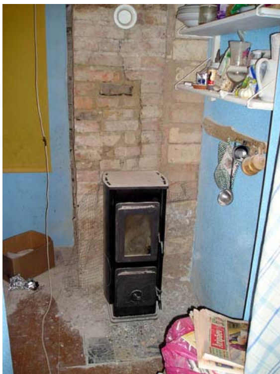
Pilt 33. Raudpliit ja halvas ehituslikus seisundis olev korsten, mida kasutati ka ventilatsiooniks
