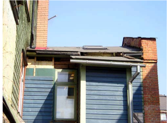
Pilt 38. Remonttööd on katusel lõpetamata, tuul puhub vahel vihma eeskoja ja põhikatuse vahelt sisse
