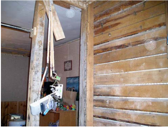
Pilt 35. Amortiseerunud elektrijuhtmestikku oli ohtlik kasutada
