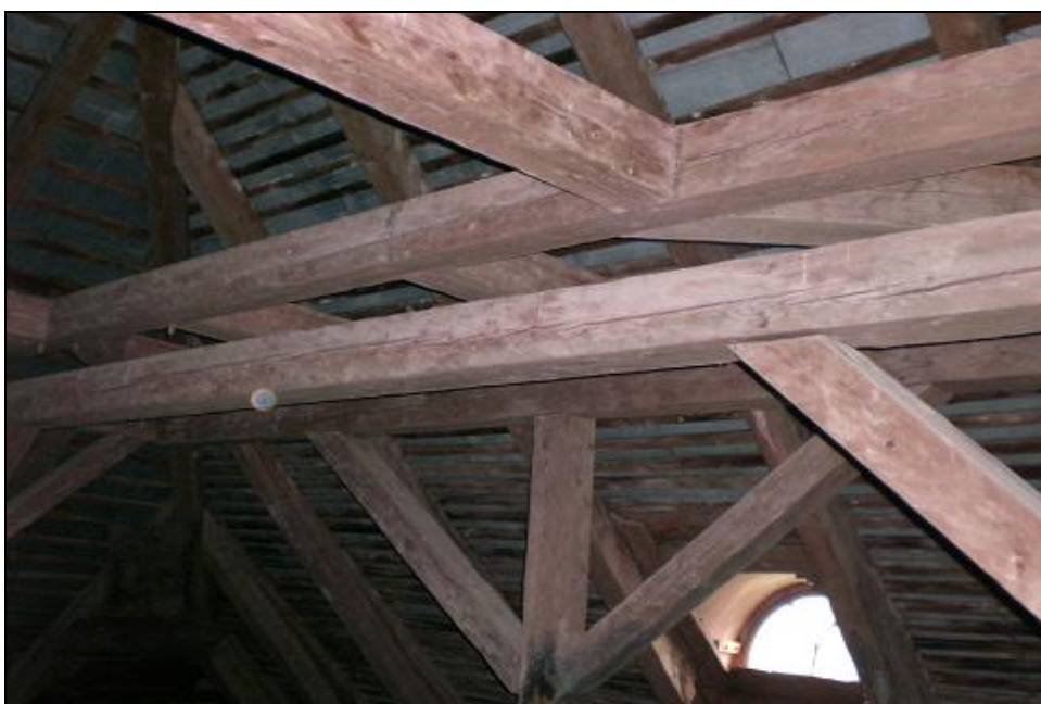
Foto 18. Katuse kandekonstruktsioonide seisukord
