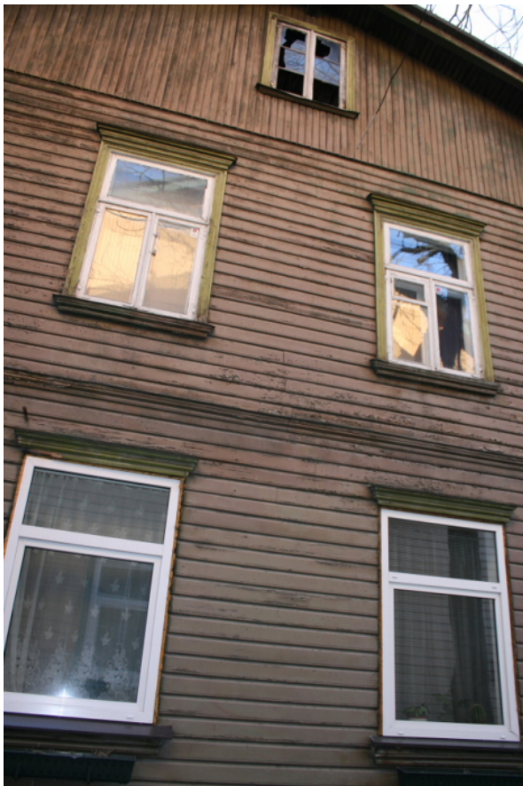
Joonis 4. Tenderpostide kahjustumine sobimatute avatäidete kasutamisel.
