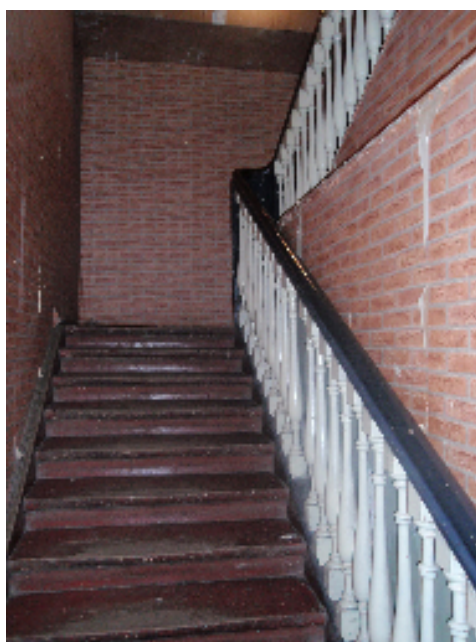
Lisa 26. Kunagise teise korruse siserõdu balustraadikatke koridoris.
