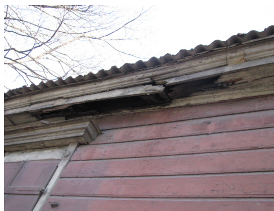
joonis 4. Hoone põhjatiivas on räästakarniis kohati lagunenu
