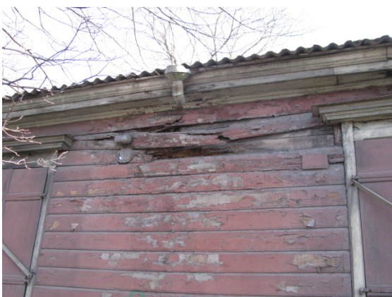
joonis 5. Kahjustunud laudis põhjafassaadil
