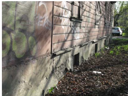
joonis 17. Põhjafassaadil katkine veelaud
