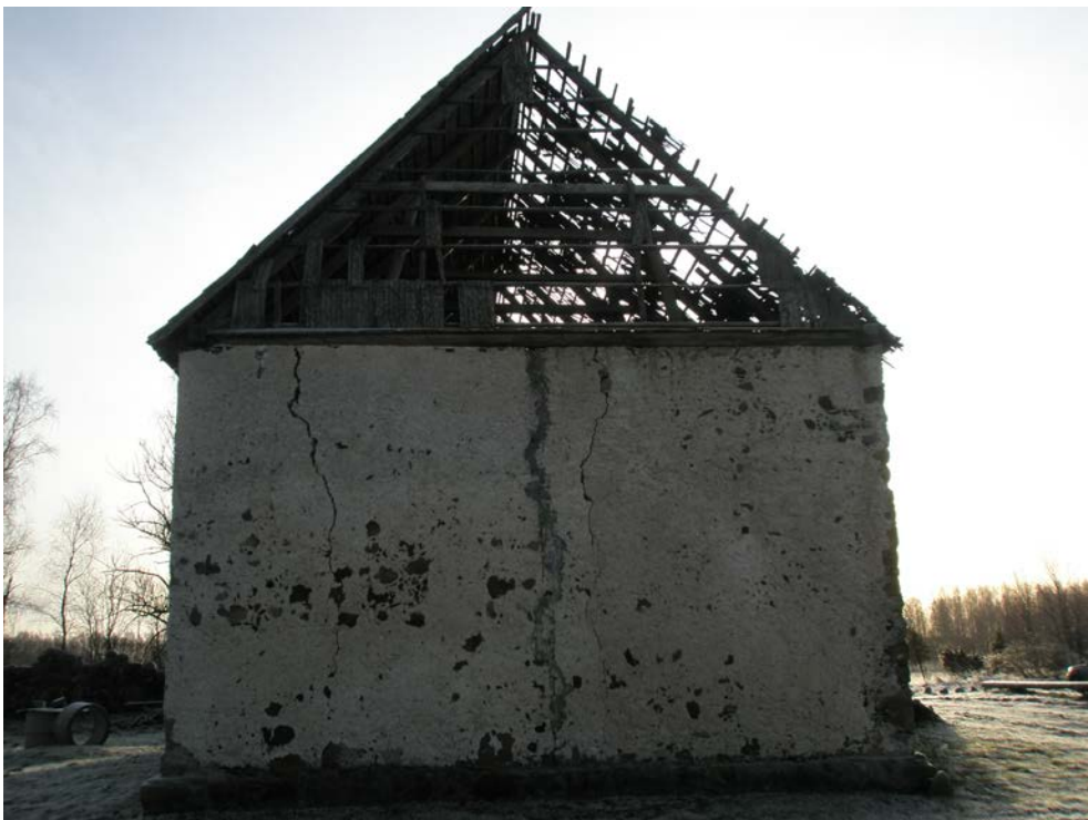
Joonis 19. Hoone kandekonstruktsioonis esineb vajumisi, mis on põhjustanud pragude tekke. Eili Siraki 2009.
