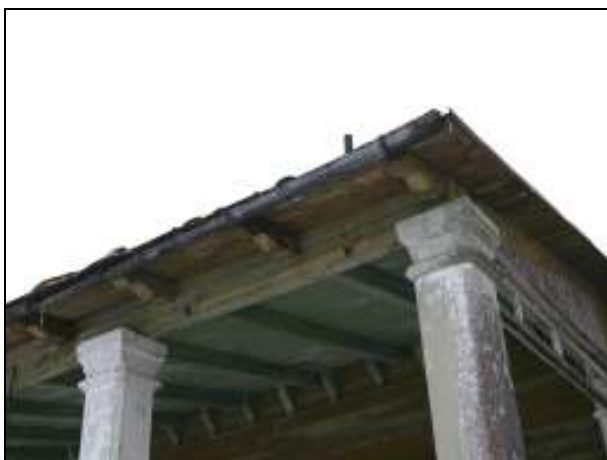
Joonis 67. Rõdu katuse samblaga täitunud vihmaveerenn ning tulemusena kahjustunud dekoratiivse saelõikega sarika otsad ning teised puitkonstruktsioonid vajavad kontrollimist.
