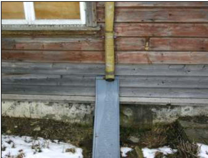
Joonis 61. Hoone esifassaadil olev katkine vihmaveetoru on saanud ajutise lahenduse.
