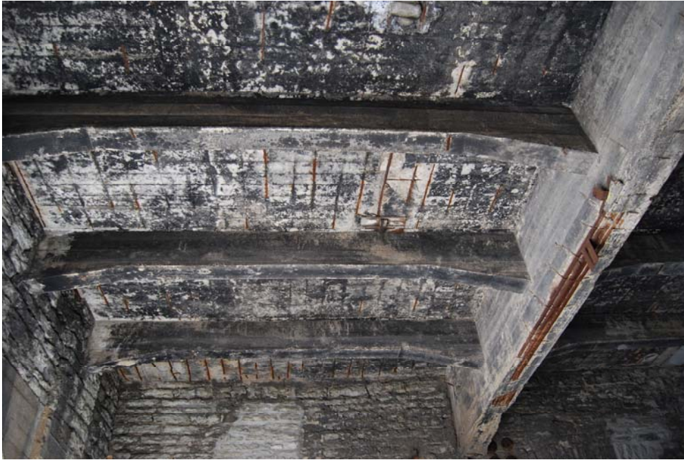
Joonis 3: Sisehoovi käigu kandekonstruktsiooni kahjustused
