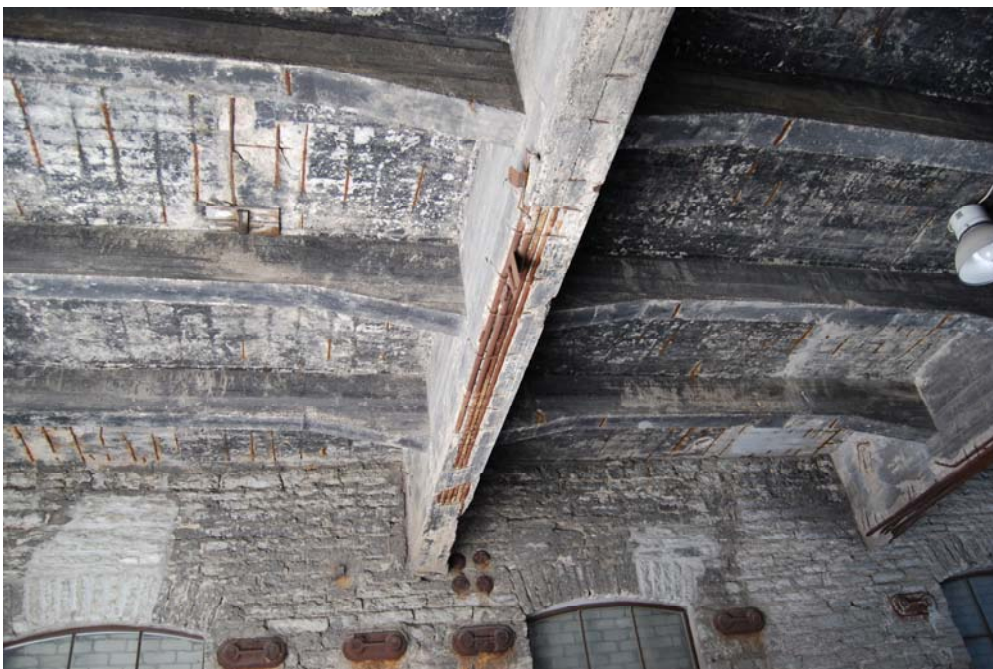
Joonis 4: Sisehoovi käigu kandekonstruktsiooni kahjustused
