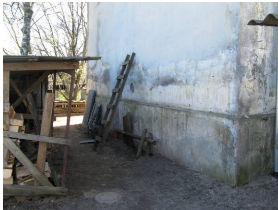
Joonis 4. Puukuuridest kahjustunud sein
