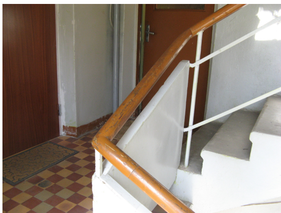
Joonis 44. Trepi käsipuu ja põranda kahhelplaadid reedavad kolmanda korruse hilisema juurdeehituse
