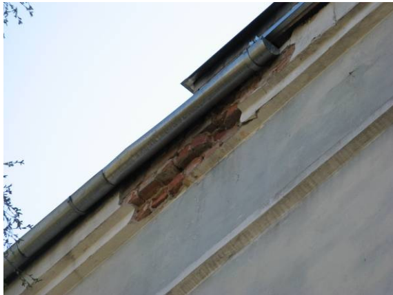
Joonis 17. Krohvikahjustused karniisil
