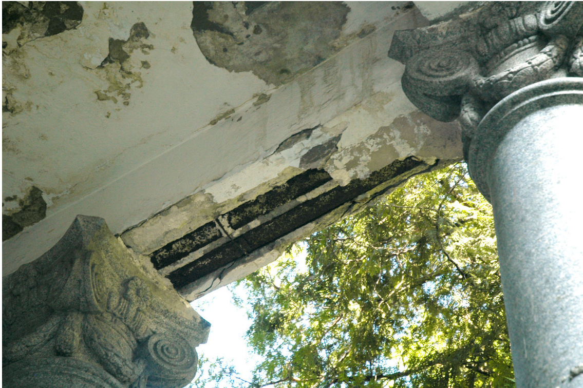
Tugevad niiskuskahjustused peahoone terrassialuses
