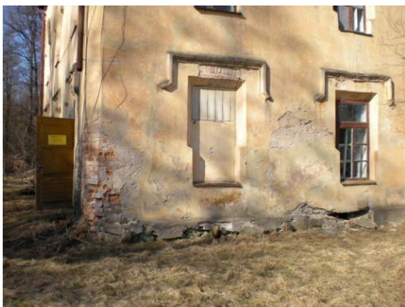
Foto 11 – Kahjustused hoone sokliosas (kirre) (21.04.2009)
