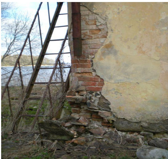
Foto 10 – Kahjustused hoone nurgal (edel) (30.04.2009)
