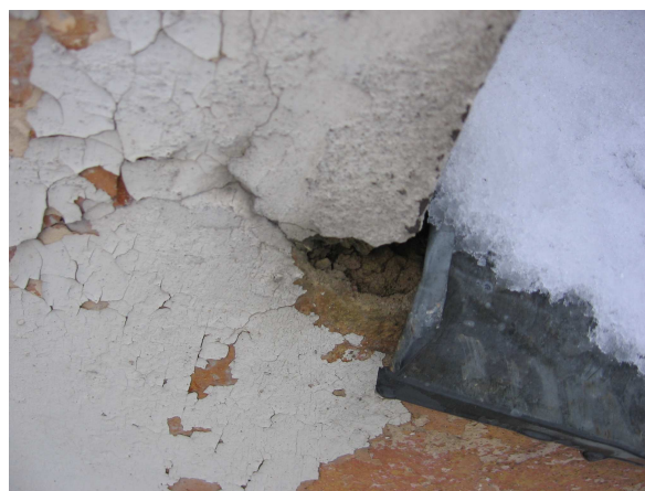
Joonis 13. Vesi on jooksnud aknapleki vahele
