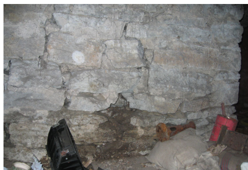
Joonis 14 Lõhenenud avariiline korstnapadi
