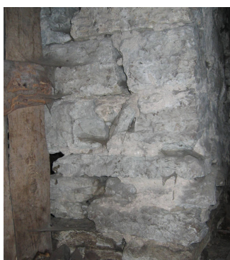
Joonis 15 Avariiline vundament
