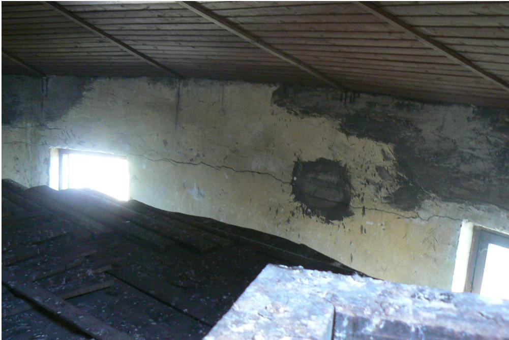
Foto 9: Betooni ja tellise erinevast soojuspaisumisest tekkinud horisontaalpragu krohvis. (autori foto)
