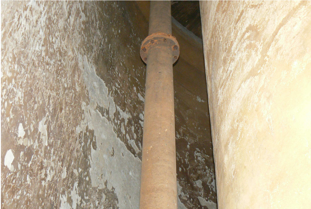
Foto22: Välise paagi välisseinas on üsna tugevasti näha pinna koorumist( autori foto)
