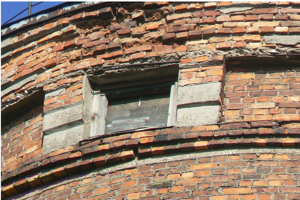
Foto 10: Räästa puudumise tõttu on katuse all olevad kivid ja ülemise rea akende peal olevad sillused täiesti lagunened.
