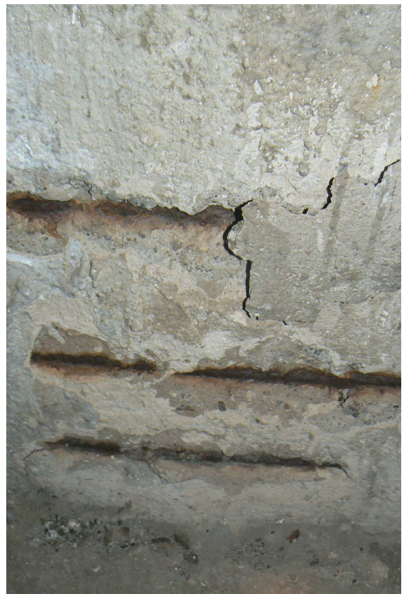
Foto19: Paagi betoonseinas on betoon armatuuri roostetamise tõttu kooruma hakanud
