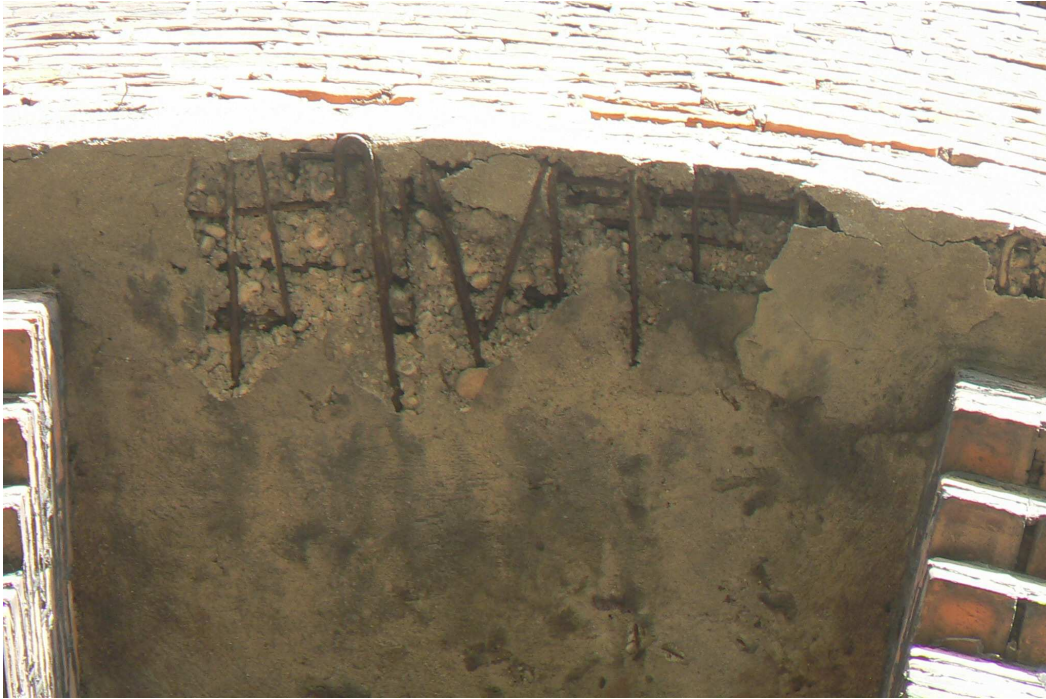
Foto 7: Veepaagi ümber olevat käiguteed toetav betoonplaat vajab parandamist. Paremas servas on näha ka peagi alla kukkuvat betooniliistakat.
