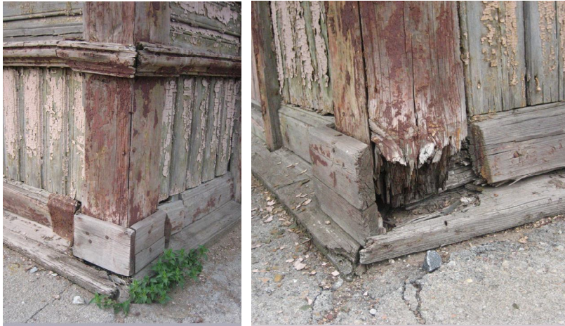
Välja vahetatud detailid põhjanurgas ja kahjustused läänenurgas
