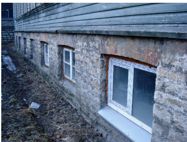
Joonis 37. Soklikorruse aknad idas
