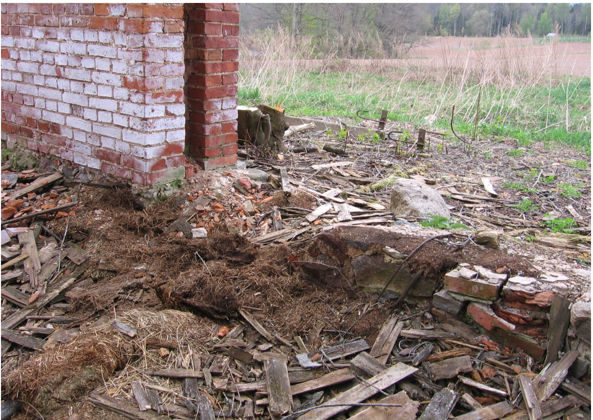
Foto 22 lõhutud vundament edelaküljel keskmes
