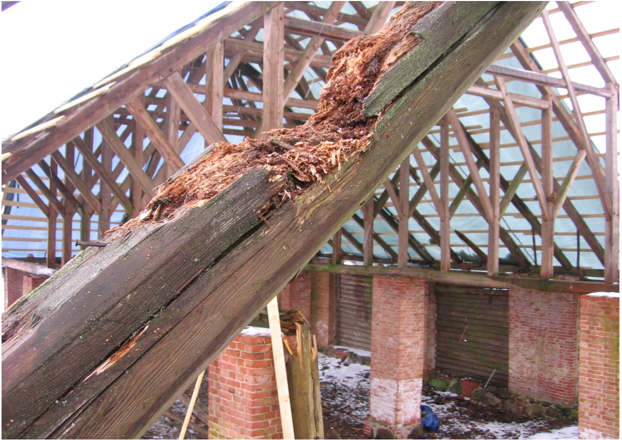
Foto 4 vaade rehe katusekonstruktsiooni mädanenud talale.
