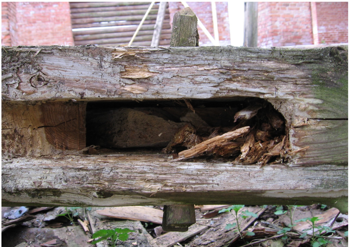
Foto 5 vaade katusekonstruktsiooni tala tapiühenduse pesale, mille tapiühendus on mädanenud.
