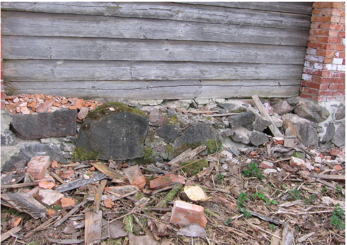
Foto 20 kirdepoolse seina vundamendi lagunenu osa
