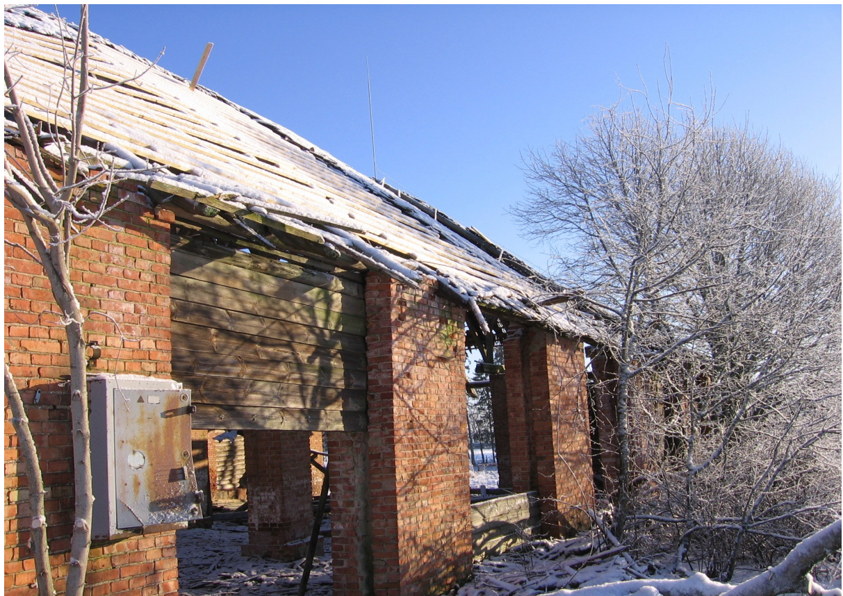
Foto 9 vaade puuduolevatele seinte osadele.
