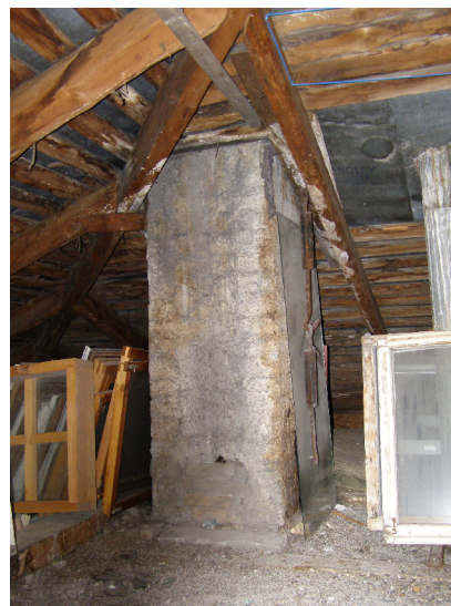
Joonis 23: Läbijooksu koht korstna läbiviigu ümbruses.
