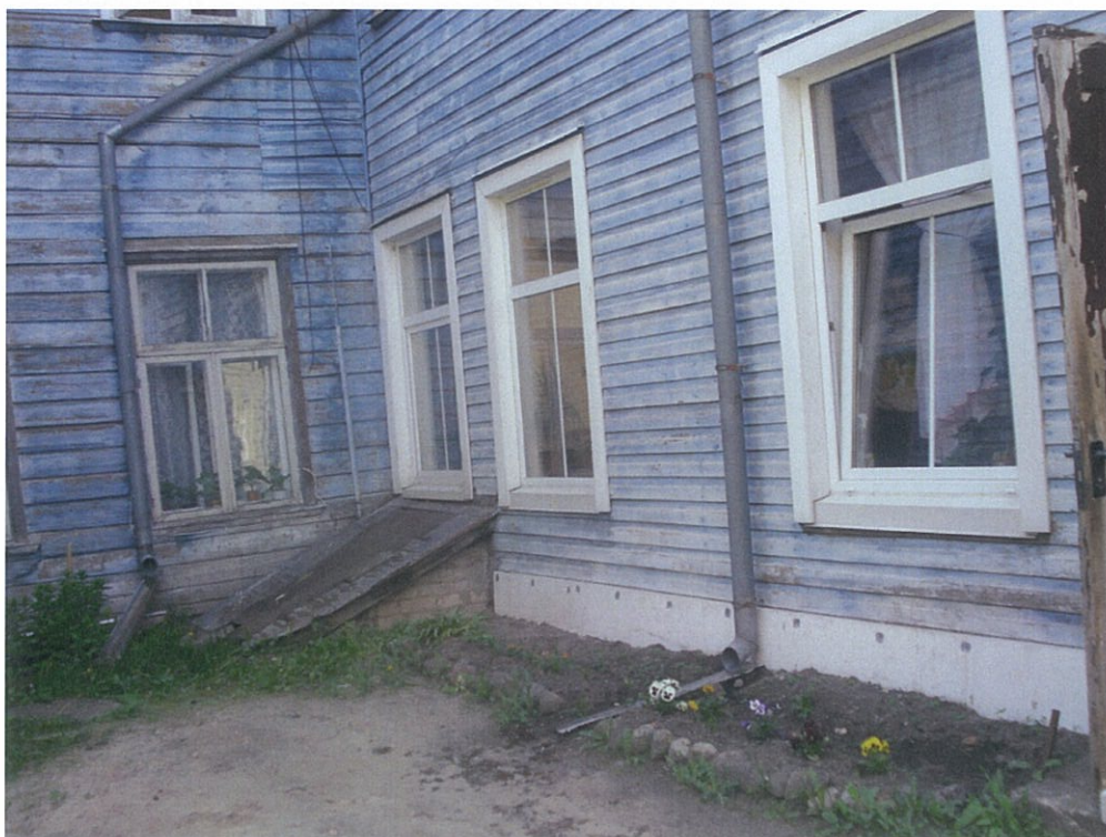
Joonis 5.3 Plastaknad, „vundamendisoojustus“, sadevete täiendav ärajuhtimine, keldriluuk
