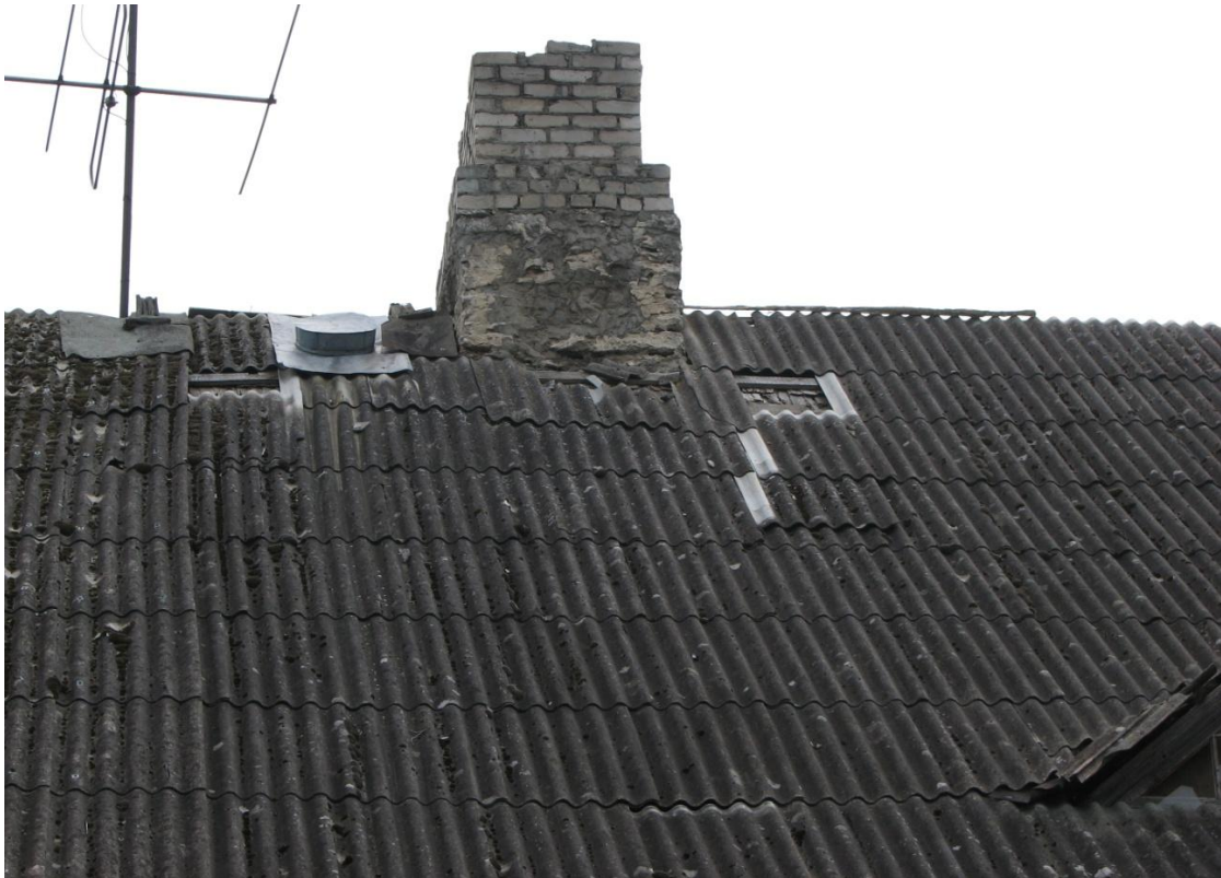
Foto nr. 7: Katusel puuduvad harjalauad ning katusekattes esineb auke. Korsten vajab taastamist.
