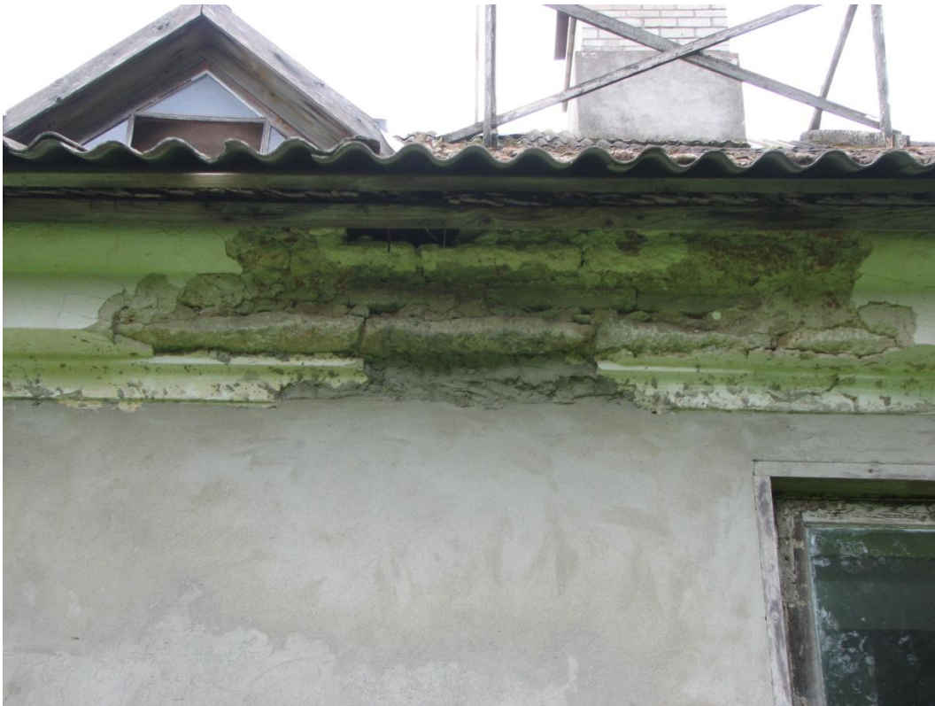
Foto nr. 6 Katuse läbijooksude tõttu on hoone karniis lagunenud. Katuse avamisel kontrollida räästa müüritise seisukorda. Vajadusel teha müüritises parandusi.
