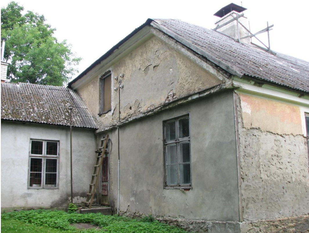
Foto nr. 5 Hoone välisviimistlus on halvas seisukorras. Krohv mõranenud ja maha tulnud. Hoone fassaadil on püütud teha krohviparandusi.
