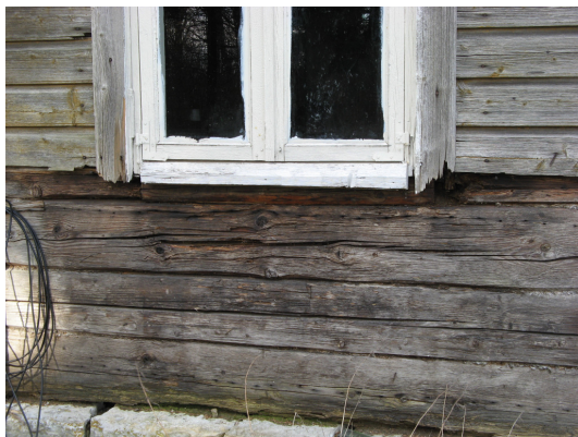
Joonis 8, Seinapalkide kahjustused
