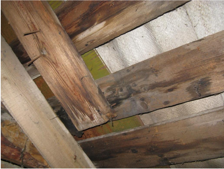
Joonis 28: Katusealune lekkekoht
