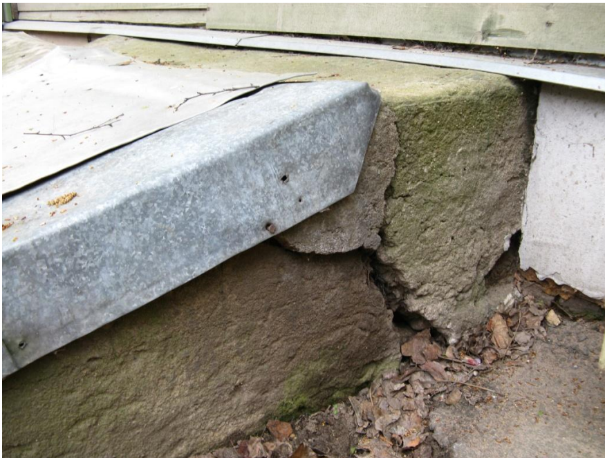
Joonis 11: Mõrad betoonist valatud vundamendis
