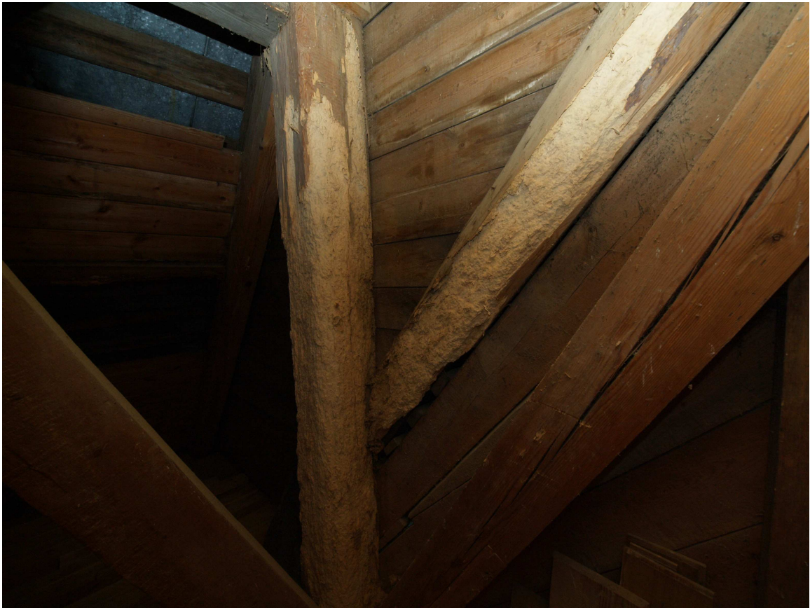
Joonis L7-12. Kahjustused kirikutorni kandekonstruktsioonis III korrusel
