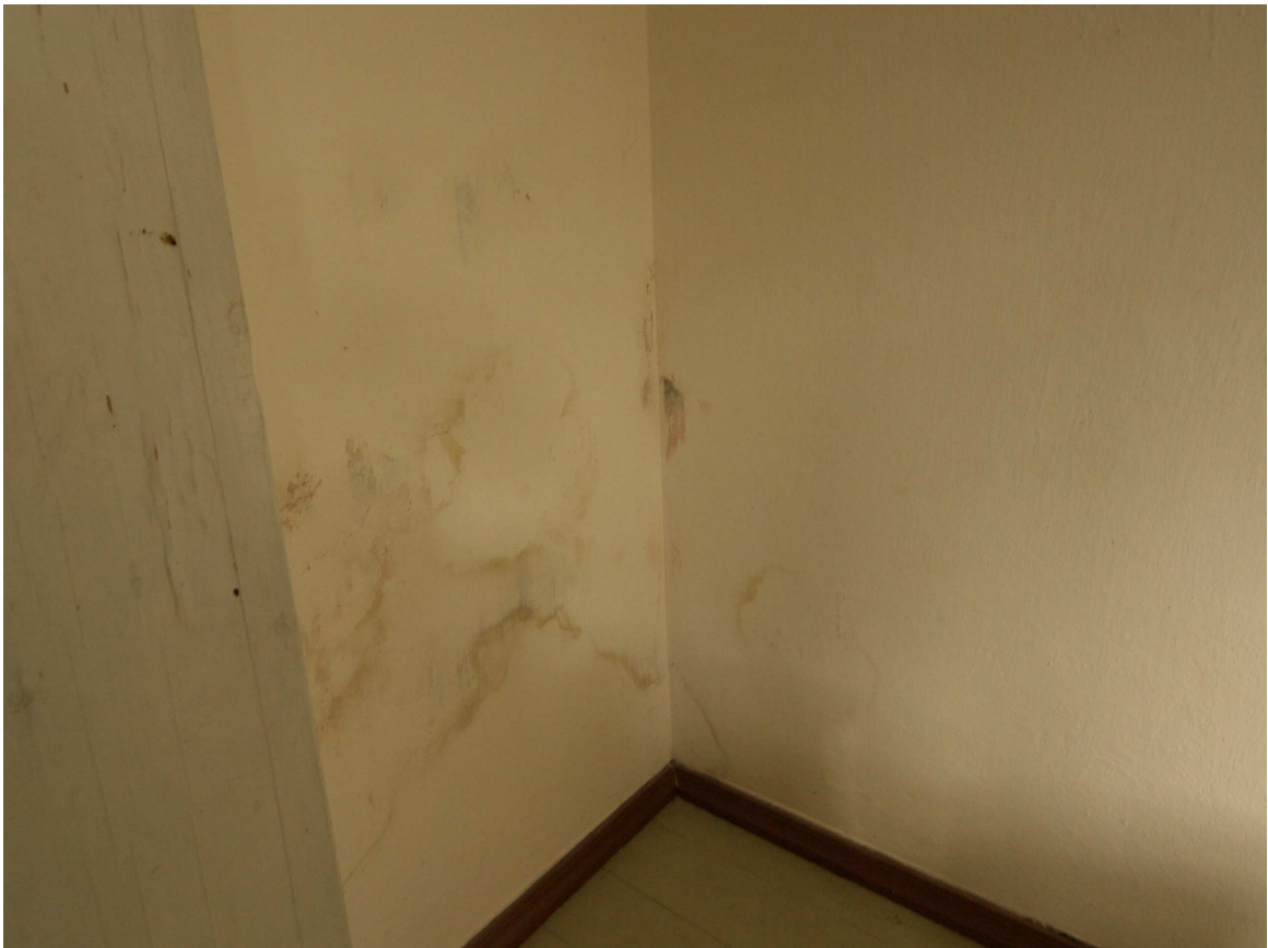
Joonis L7-16. Niiskuskahjustused põhjakülje välisseina alaosas
