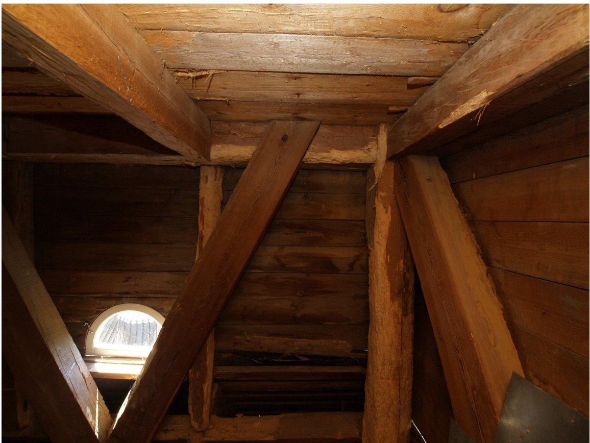
Joonis L7-13. Kahjustused kirikutorni IV korruse lõunapoolsele seinale
