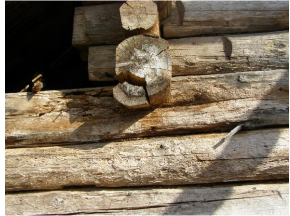
Joonis 21, Kahjustunud rehetoa nurk, väljast
