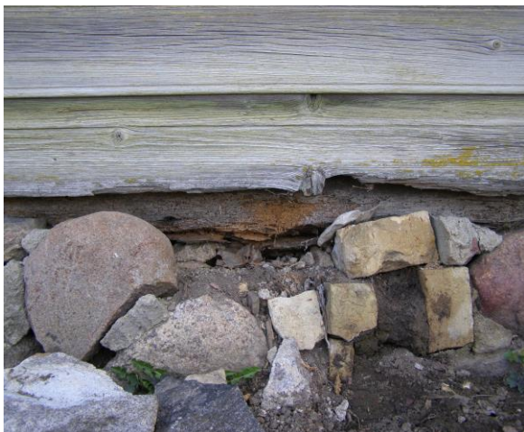
Joonis 16, Kahjustatud aluspalk idaküljel
