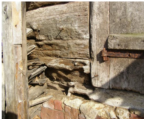
Joonis 17, Kahjustatud aluspalk lääneküljel
