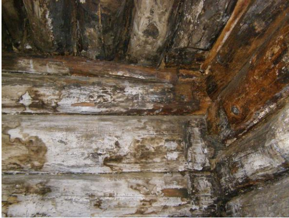
Joonis 20, Kahjustunud rehetoa nurk, seest
