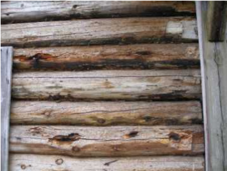
Joonis nr. 8 Läänepoolse seina kahjustus.
