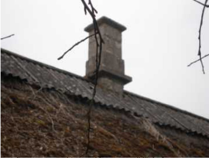
Joonis nr.17 Kahjustatud katus eterniidilt jooksva vee tõttu.
