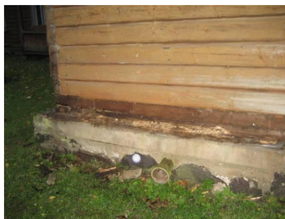
Joonis 7. Tsemendiga parandatud vundament.
