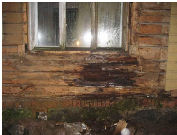
Joonis 9. Mädanikust kahjustatud köögi sein.
