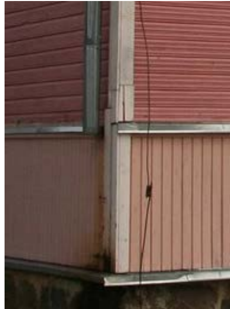
Foto 9. Põhjafassaadil olevalt veelaualt voolab vesi seinale. Foto: S. Mälk, aprill 2010.
