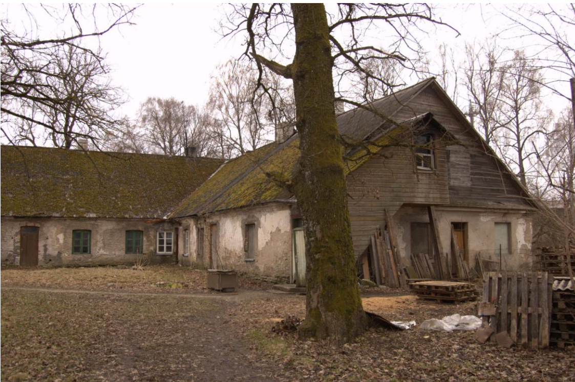
o) Foto Tall-tõllakuuri vaade põhjast 2010a. Ülemine aken toodud mujalt paigaldatud 1990-tel. Alumistel akendel säilinud 20saj.alguse nurgad ja hinged.
