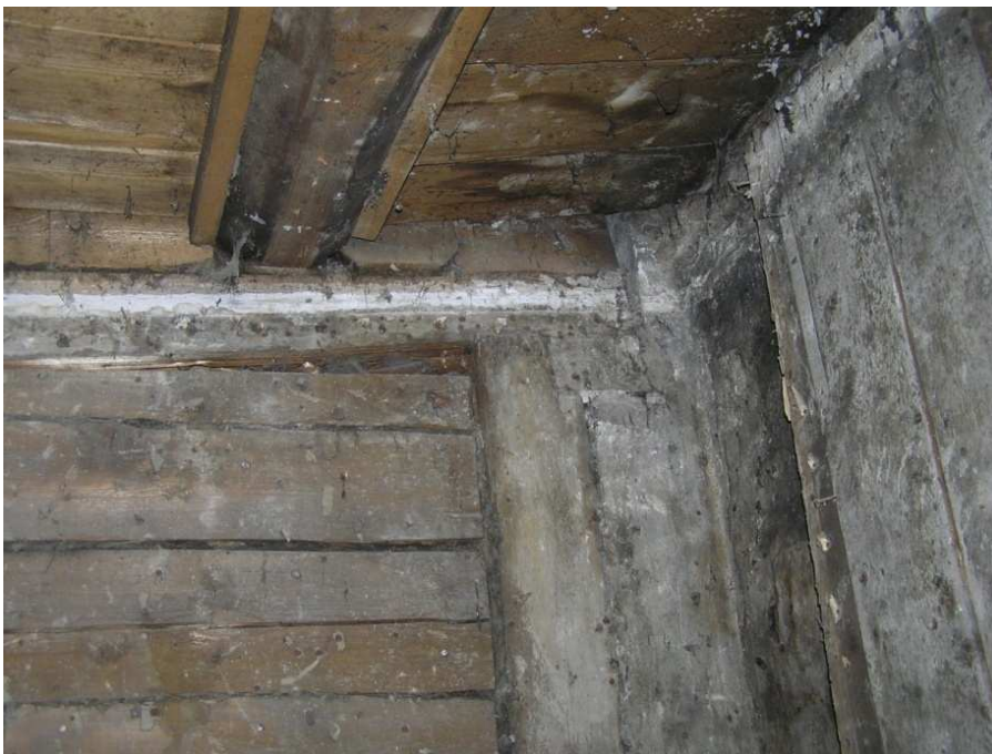
FOTO 26: Hoone vaheseinad on ära vajunud, seoses täiendavate avade tegemisega seinad.
