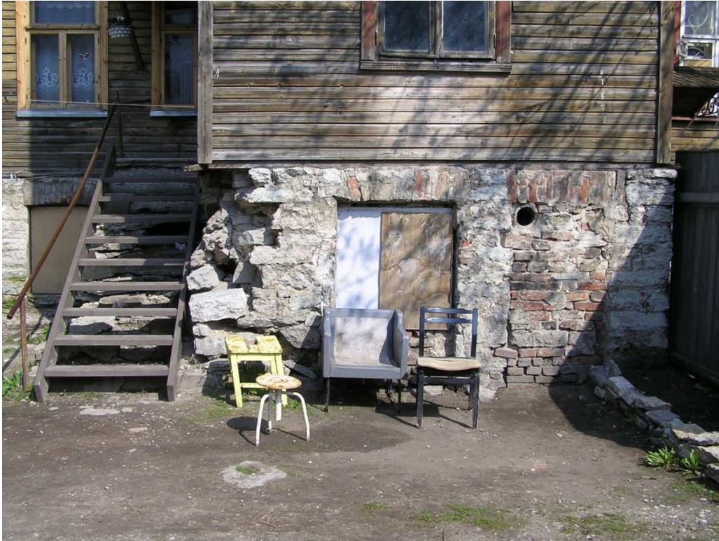
FOTO 19: Hoovipoolne trepikoda – kahjustunud sokliosa ja trepp.
