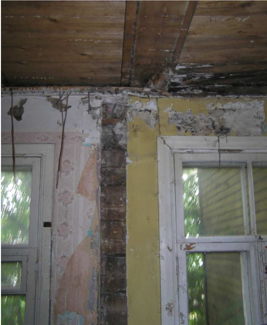
FOTO 25: Hoone ülemised rõhtpalgid on osaliselt kahjustatud niiskusest
