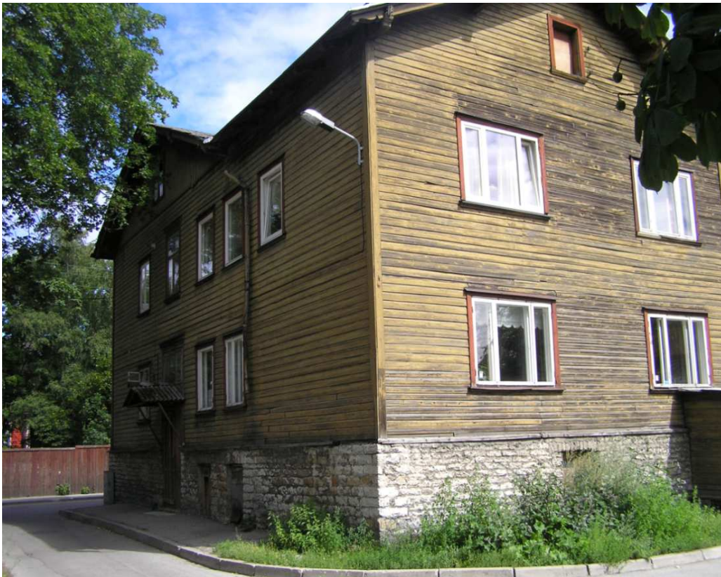
FOTO 20: Hoonel puuduvad vihmaveerennid ja äravoolutorud tugevalt kahjustunud. Sadeveed jooksevad otse seinale ja vundamendile.
