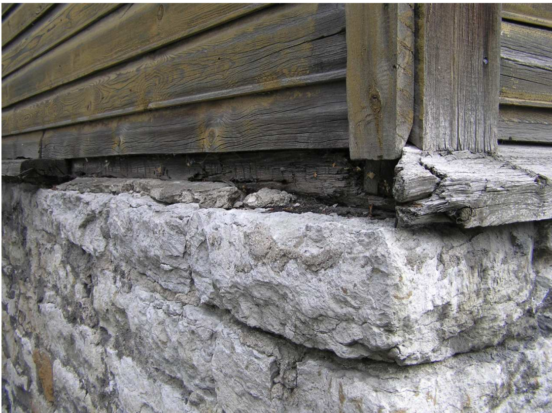
FOTO 24: Maja alumised rõhtpaldid on niiskusest kahjustunud. Veelaud puudulik. Voodrilaud kinnitatud ilma tuulutavahet jätmata.
