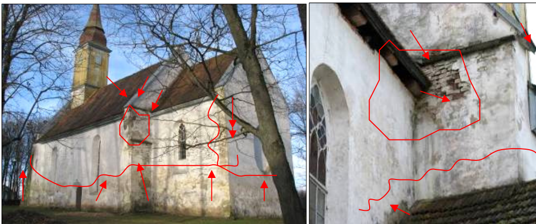
Joonis P.3. (a) Puhja kiriku lõuna fassaad ja (b) kirde fassaadi nurk. ( Sadeveest ja maapinnast kapillaarselt tõusev niiskus on näidatud nooltega ja joonega on iseloomustatud vee liikumist fassaadil ) Foto: Maksim Kurotskin 2008 a . sügis.
