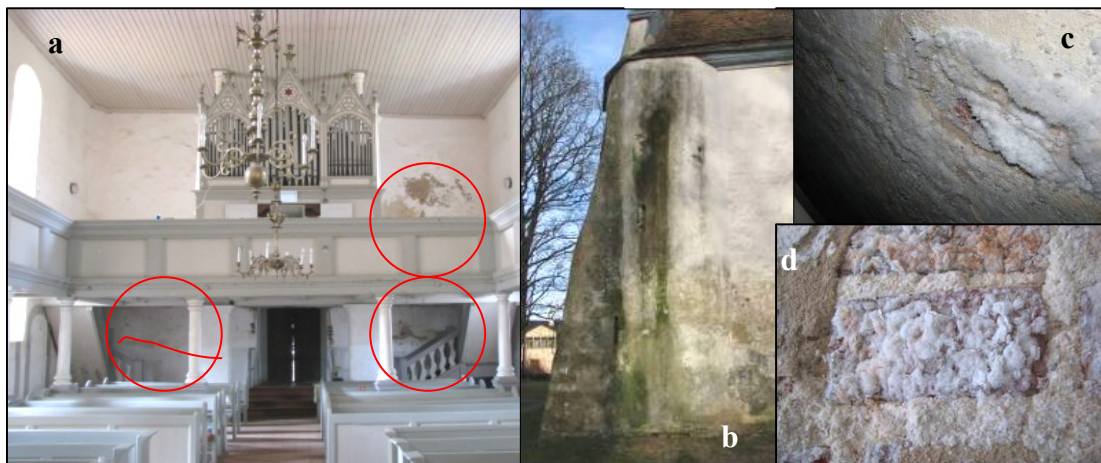
Joonis P.6. (a) Puhja kiriku põhja lääne sein; (b) lõuna fassaadi tugipiilar-tornitrepp; (c) soolakahjustus krohvil; (d) sügav soolakahjustus tellisel Foto: Maksim Kurotskin 2008 a. sügis / 2010 a. talv
