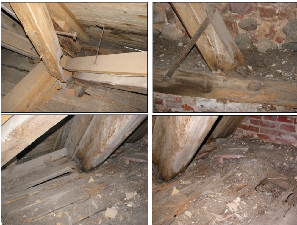
Joonis P.9. Puhja kiriku mõningad vigastatud pööningu sõlmed.
