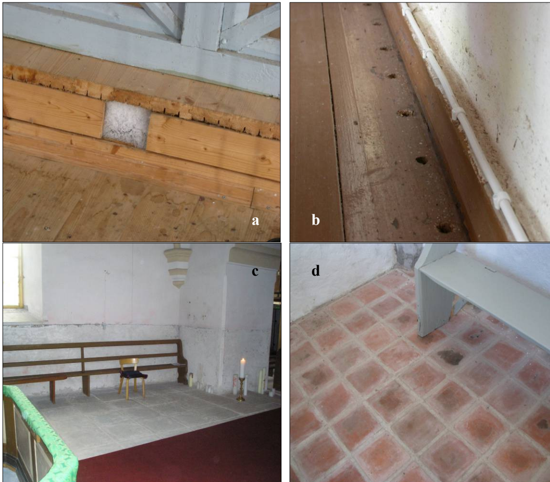
Joonis DP.7. (a) Sangaste kiriku põrand, jäätunud vent. ava; (b) Rannu kiriku põrand, vent. avadega ; (c) Jõelähtme kiriku plaatpõrand (d) Puhja kiriku plaatpõrand, tumedad laigud viitavad põrandaalusele niiskusele.
