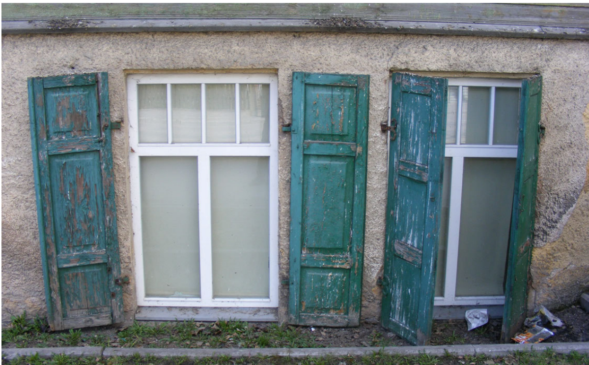
Joonis nr 17. Hoone Tähe tn poolsed uued soklikorruse aknad on puidust ühekordse raamiga. Allikas: Edgar Kaare, aprill 2010.
