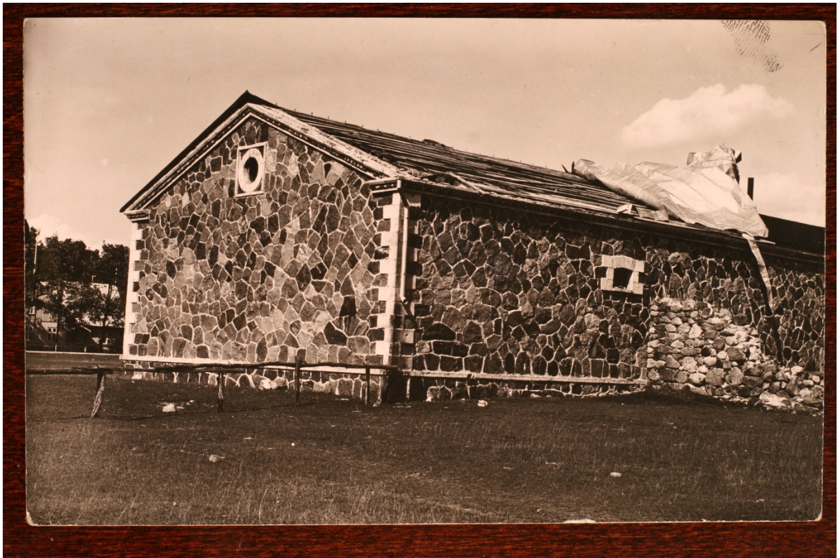
Foto 29 – 1936.a tormis kahjustunud katuse valtsplekk-kate
