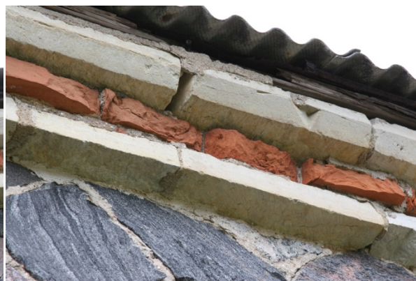
Foto 49 – karniisi kahjustunud tellisekiht
