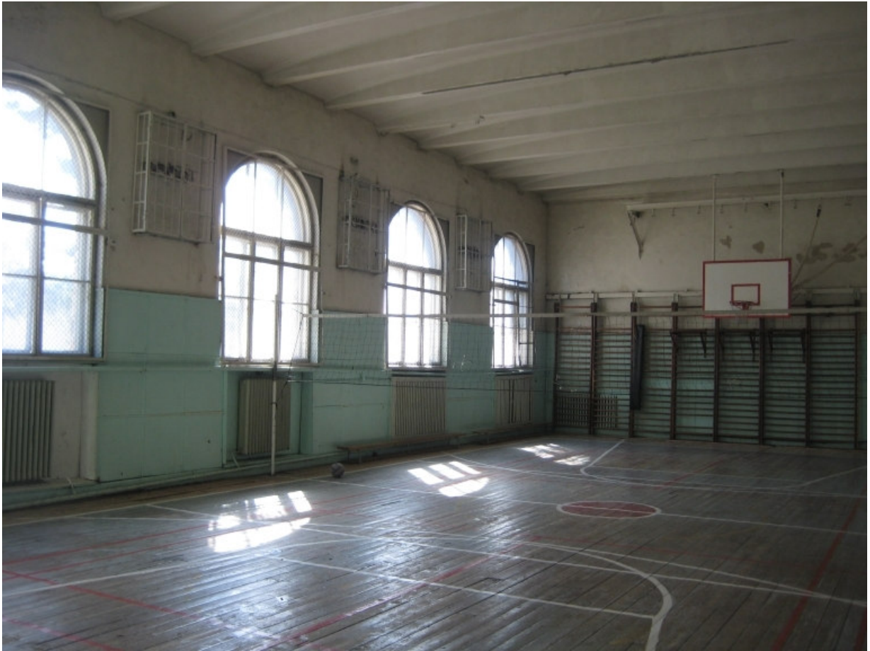
Foto 27. Sisevaade võimlasse aastal 2010. Saali lae moodustavad R/B katuse kumerplaadid, akendeks algsed originaalaknad. Otsaseinas on näha algsed metallist konstruktsioonid võimlemisatribuutika kinnitamiseks. Seintel vineertahveldus.
