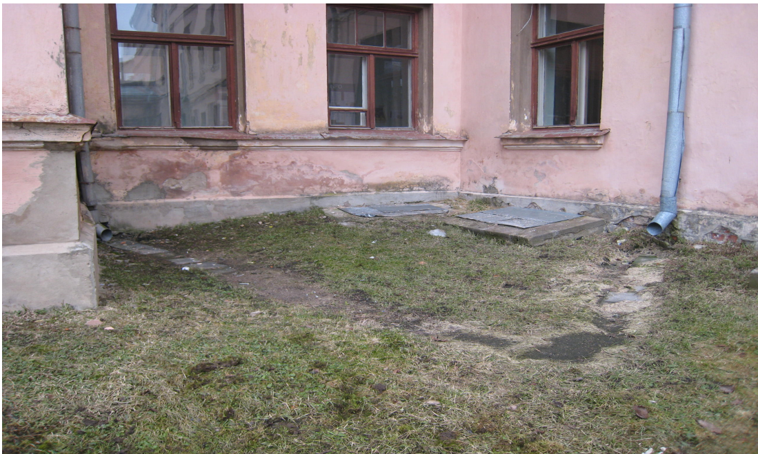
Foto 10. Vaade hoone läänepoolsele soklile. Näha on niiskuskahjustused, kinnikaetud valgusšaftid keldriakende ees ja esimese korruse koridori originaalaken koos plekiga.
