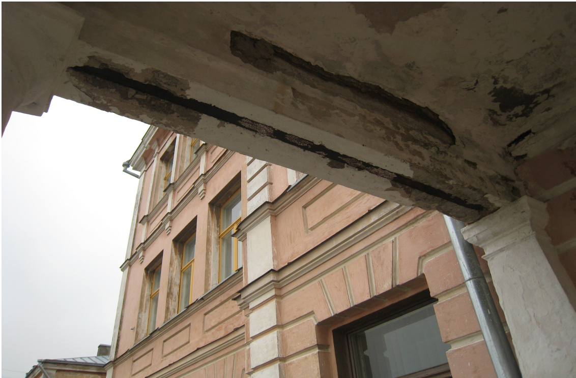
Foto 16. Rõdu kahjustustega kandetala. Terastalade betoonivabad pinnad tugevalt roostetanud
