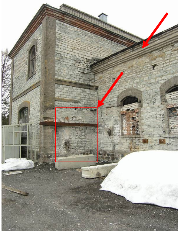
Foto 15: Administratiivkorpuse kinnimüüritud ukseava ja kõrgemaks ehitatud räästas ning valgetest tellistes karniis
