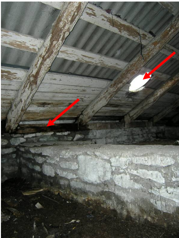
Foto 35: Administratiivkorpuse katusekonstruktsioonid, katmata katuseluuk ja märgunud müürlatt
