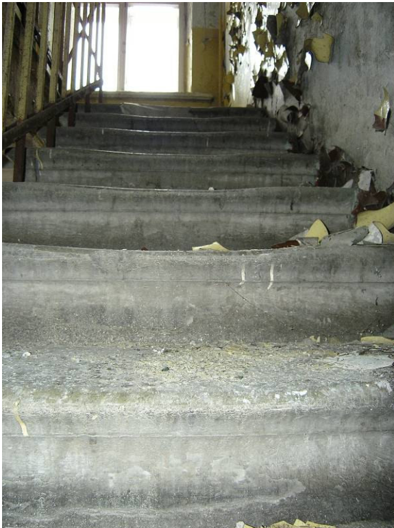
Foto 42: Administratiivkorpuse kulunud astmetega kivitrepp
