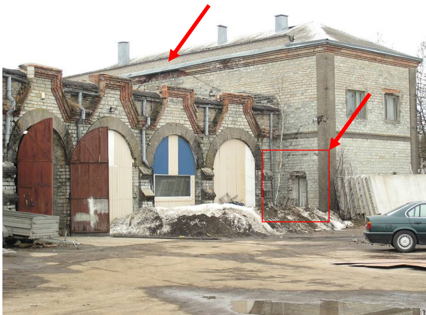
Foto 14: Administratiivkorpuse hilisem ukseava ja kummaline parapet
