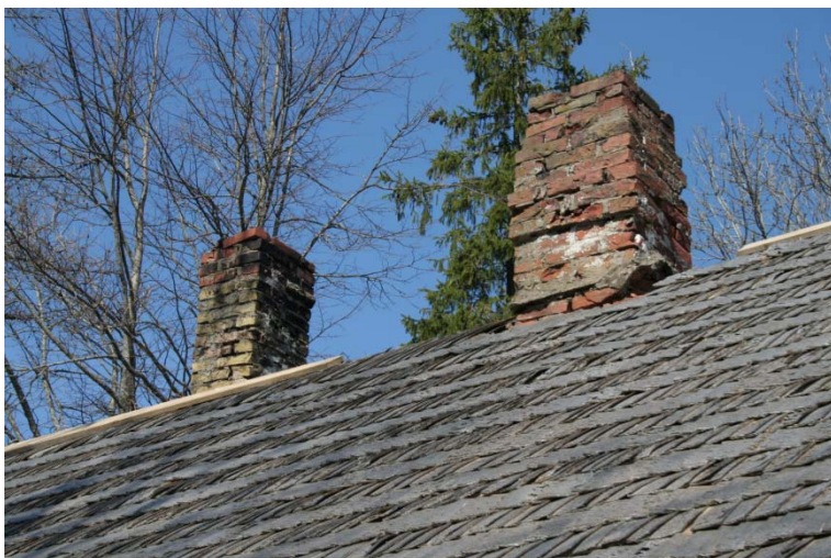
Foto 44. Korrastamist vajavad korstnad
