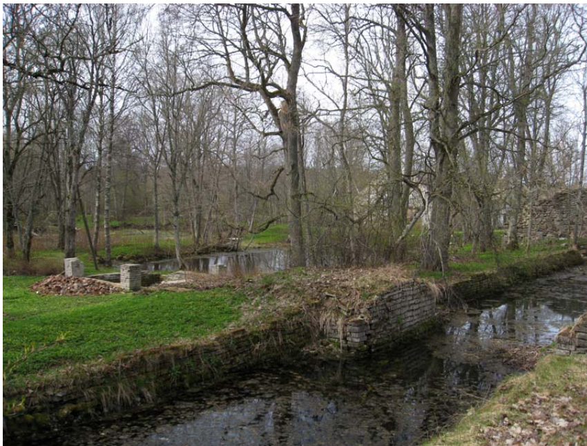
Foto 34. Tõllapesukanali rohtukasvanud seinad ja osaliselt lagunema hakanud üle kanali viinud silla tugiseinad. Kanali põhi kivirisu ja lehesodi täis. Autori foto 2011
