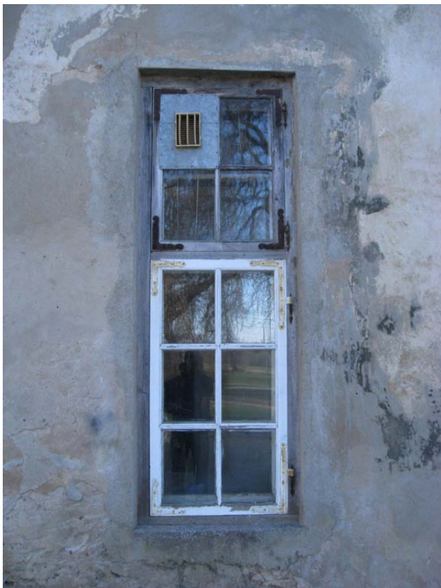
Foto 23. Mõtmete akendele, eeskätt endise restorani oamdele, on paigaldatud sobimatuid ventilatsiooniluke. Autori foto 2011
