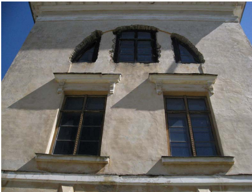
Foto 5. Lohakalt paigaldatud friisi ja akende veeplekid, mis osaliselt ka puuduvad, soodustades niiskuskahjustusi krohvile ja värvile. Autori foto 2011
