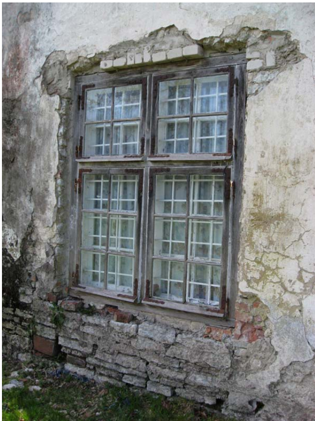
Foto 8. lagunenud akna pale ja sobimatud parandusvõtted silikaattellisega. Autori foto 2011
