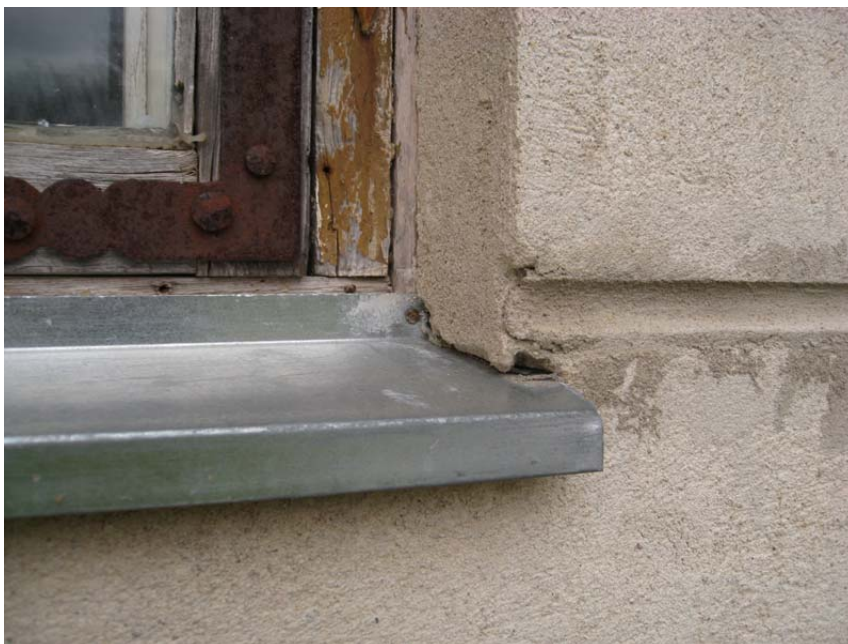
Foto 6. Lohakalt paigaldatud aknaplekk, mis soodustab konstruktsioonide märgumist. Autori foto 2011
