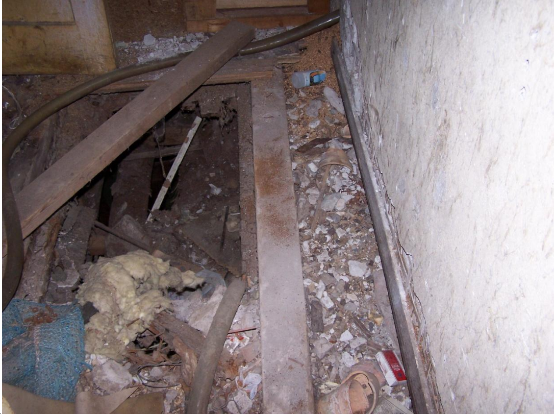
Joonis 15. Mädanikkahjustusega vahelagi katusekorrusel
